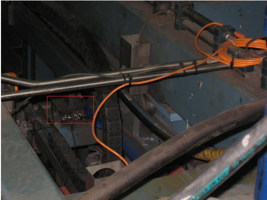
Kuva 26 Sylinterin nykyinen kiinnitys kelkkaan (Yliverronen. 2014)
