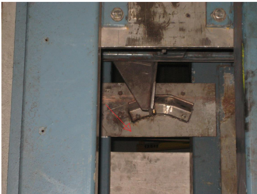
Kuva 16 Hissien ohjuripala (Yliverronen. 2014)
