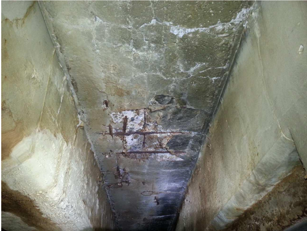
Kuva 15. LTO-tason holvin alapinnassa raudoitteet näkyvissä.
