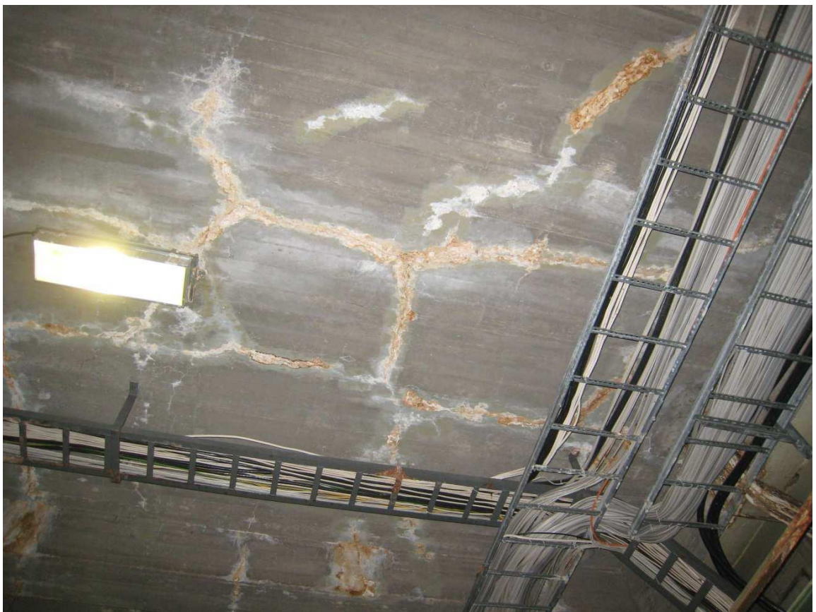
Kuva 9. Halkeilua laatan alapinnassa konetason hoitopuolen katossa.
