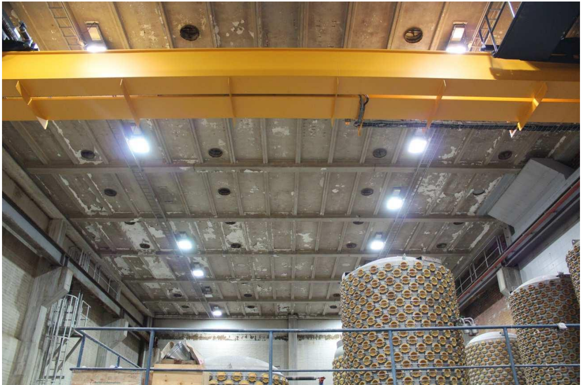
Kuva 14. Välikatton ripa- ja ontelolaattaelementtien pinnoitteen vaurioita
