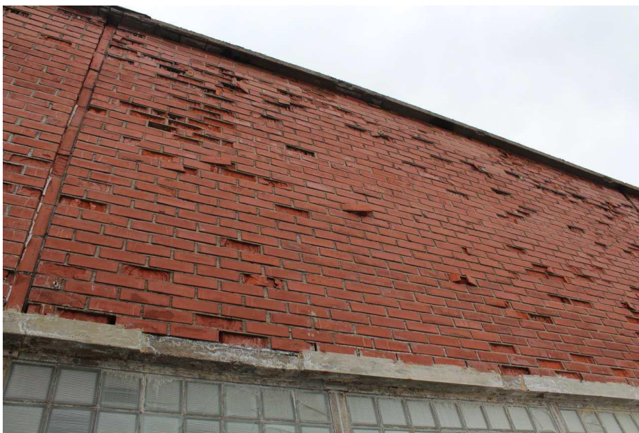
Kuva 17. Tiiliverhoilussa ilmenneitä halkeamia ja irtoavia tiilen paloja.
