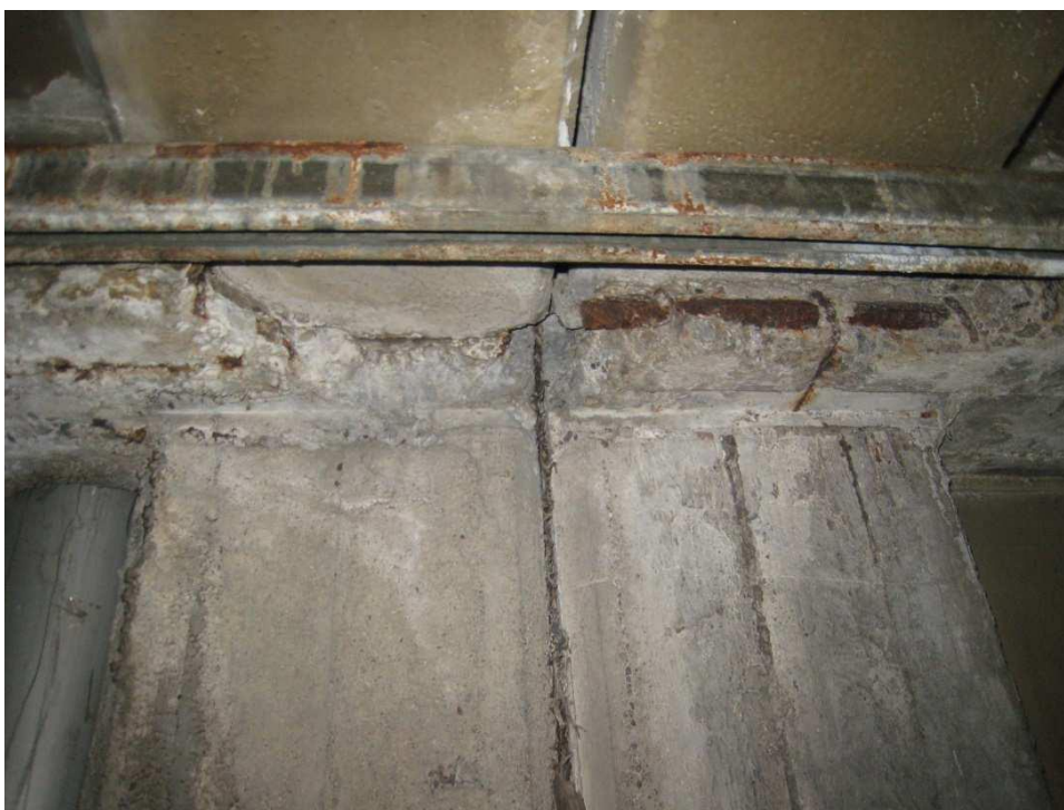
Kuva 10. Välikaton niskapalkissa halkeamia.
