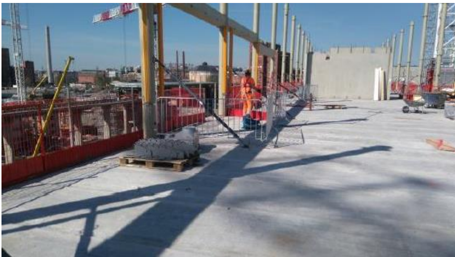
Kuva 27. Putoamisvaara-alue on rajattu. (SRV 2016)
