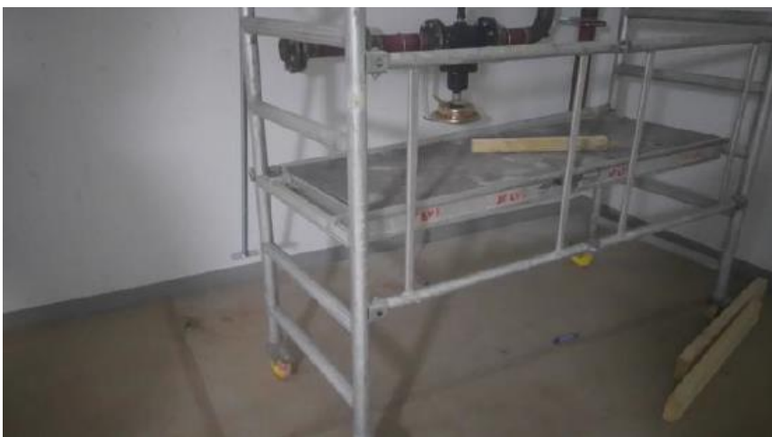
Kuva 14. Asennustelineestä puuttuu nousutie. (SRV 2016)
