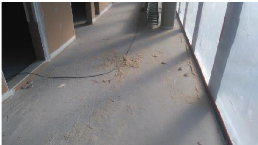
Kuva 15. Alue on siivoamatta työn jälkeen (SRV 2016)
