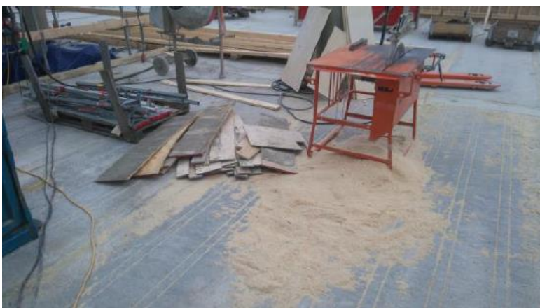
Kuva 18. Sirkkelin ympäristö on siivoamatta ja sirkkelin vieressä kuuluu olla jätteastia. (SRV 2016)
