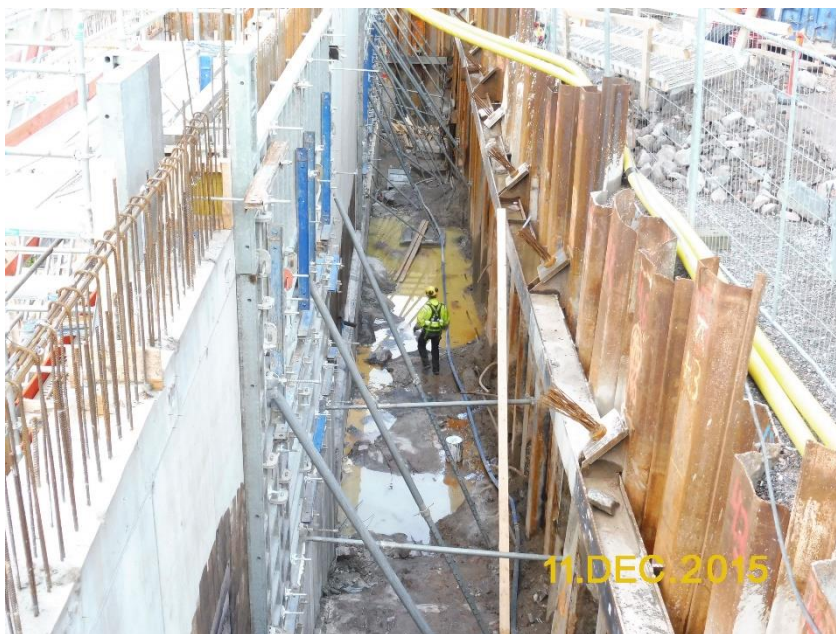
Kuva 1. Vettä rakennuksen pohjamontussa (SRV 2015)
