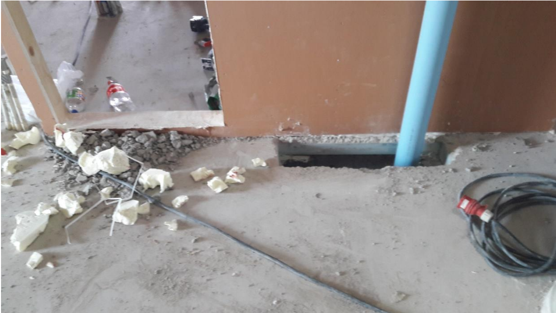
Kuva 21. Aukkosuoja on jätetty asentamatta. (SRV 2016)
