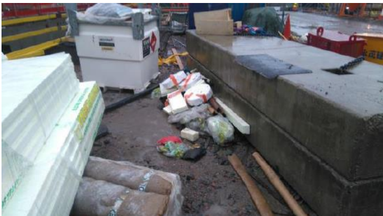
Kuva 17. Jättekasa ja jätteastia puuttuu. (SRV 2016)
