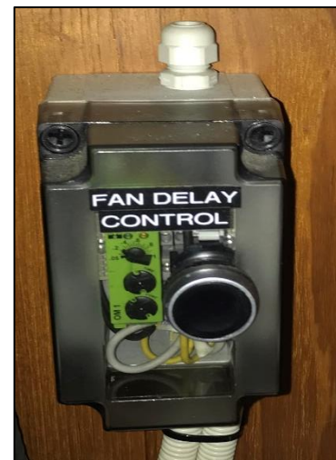
Konehuoneen tuuletusimurin käyttökytkin
