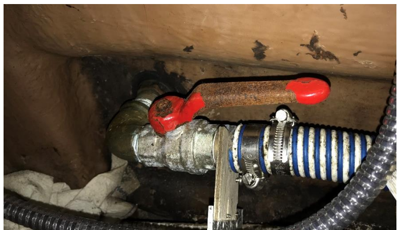
Keula-WC:n pesualltaan tyhjennyslöpivienti
