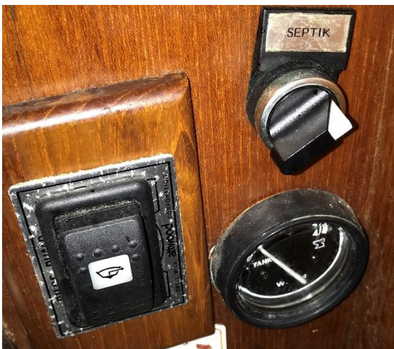
Keula-WC:n lattiakaivon tyhjennyspumppu ja septitankkimittari
