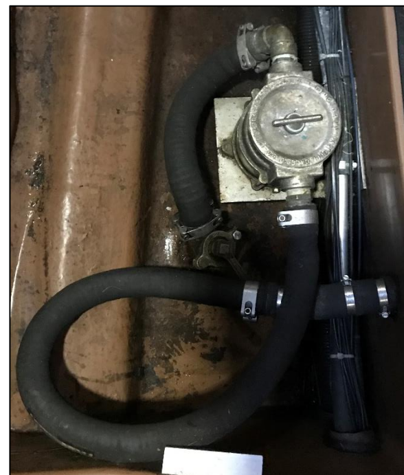
Merivesijäähdyttimen sulkuventtiili ja suodatin
