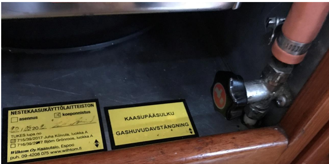
Kaasupääsulku liedien alla
