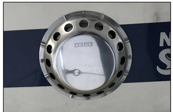
Liesituulettimen poistoputki kannella
