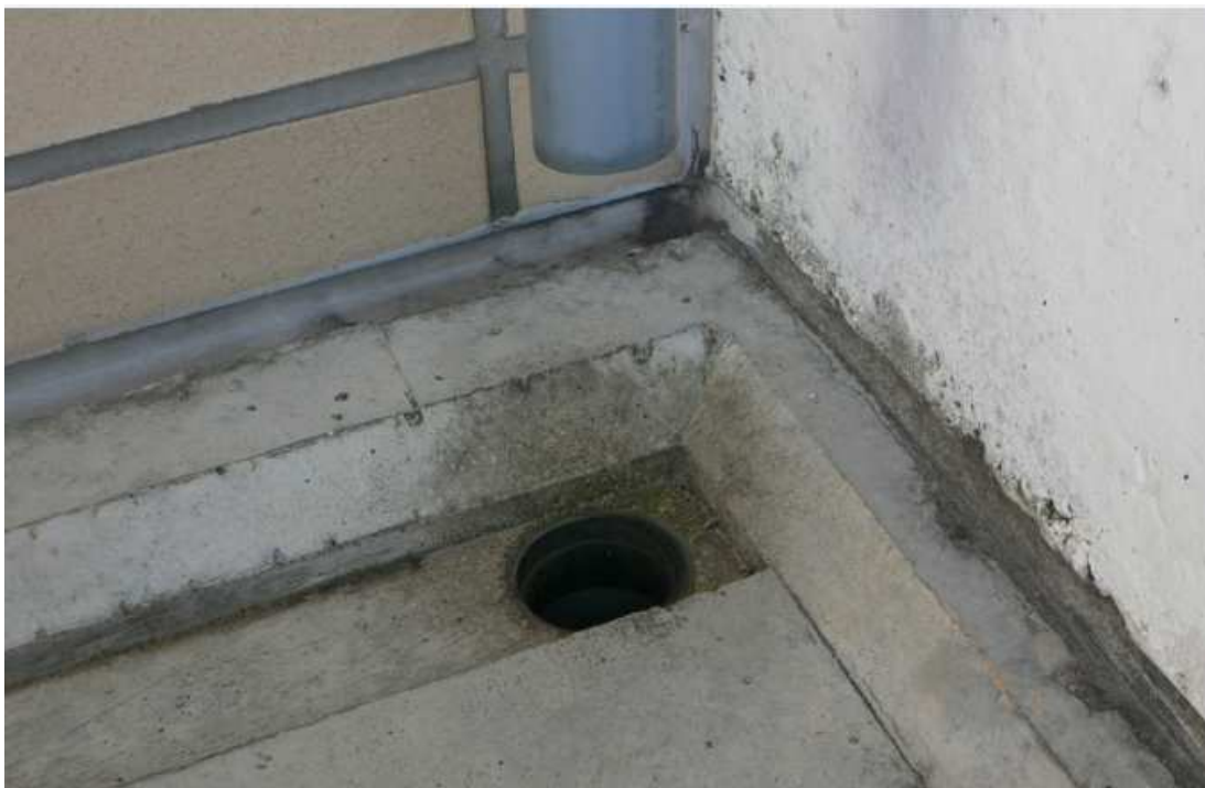
Kuva 3. Parvekkeen jatkamattomasta vedenpoistoputkesta (kuvannut Timo Urpulah-ti).
