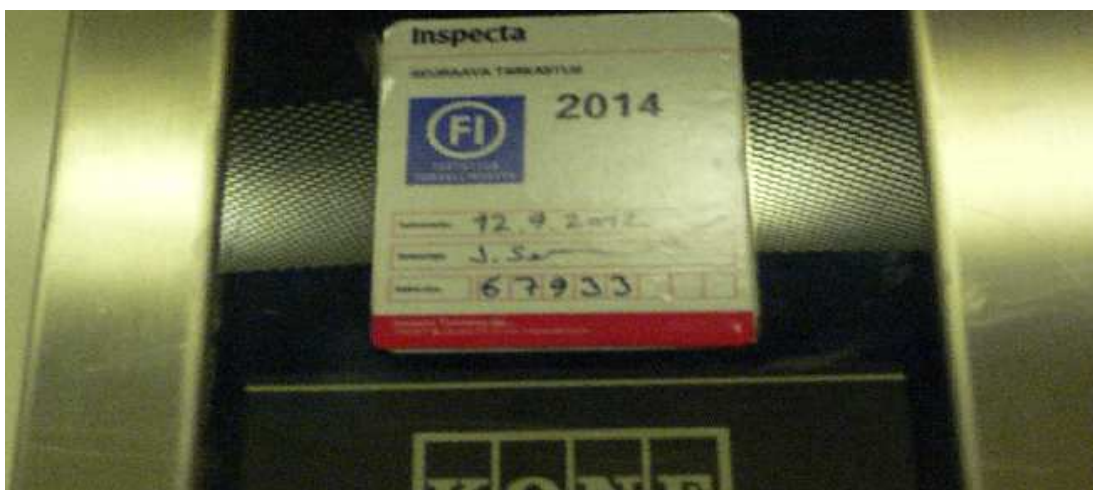
Kuva 29. Hissin tarkastuskortti (kuvannut Timo Urpulahti).
