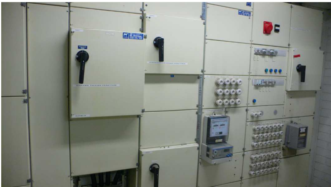
Kuva 20. Sähköpääkeskus (kuvannut Timo Urpulahti).
