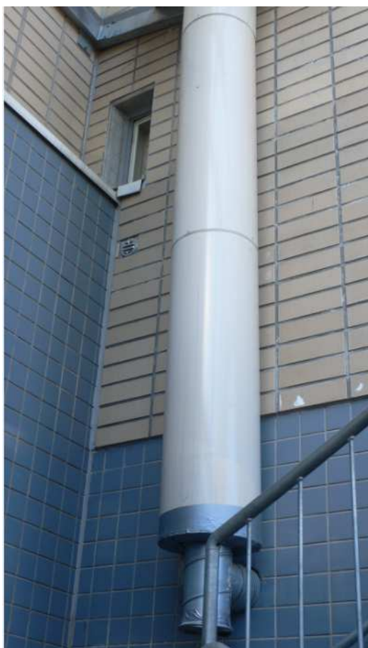
Kuva 25. Jälkiasennettu katolle menevä ilmastointikanava (kuvannut Timo Urpulah-ti).
