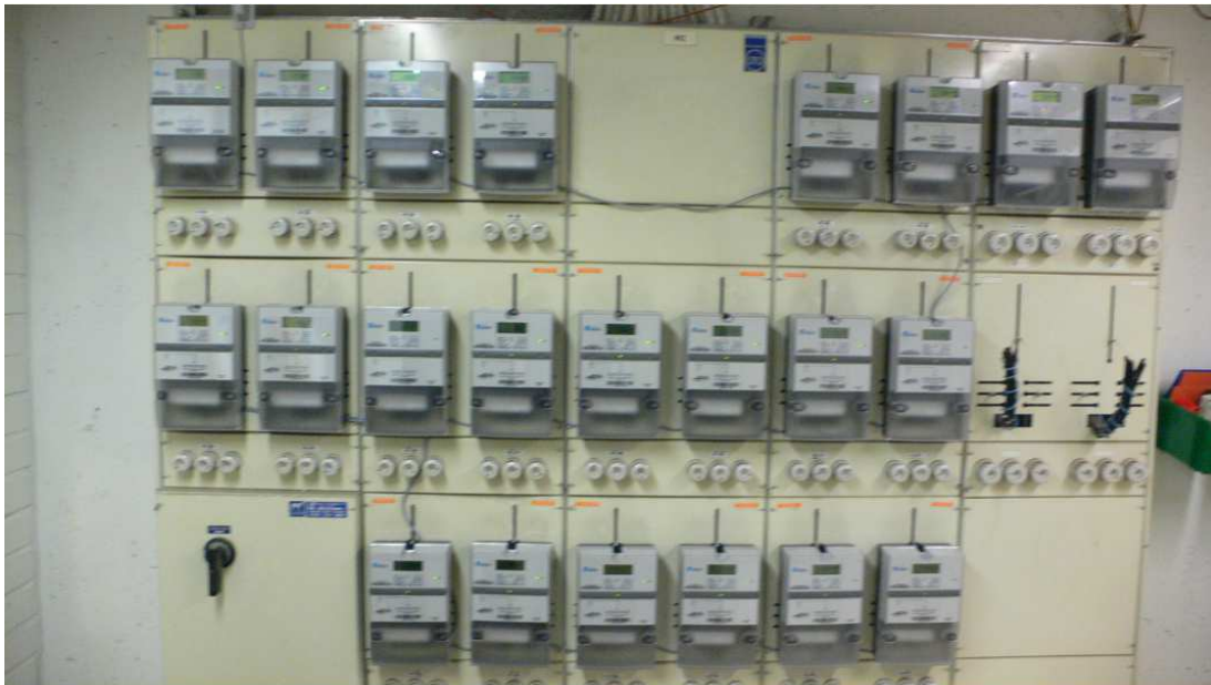
Kuva 19. Sähköpääkeskus (kuvannut Timo Urpulahti).
