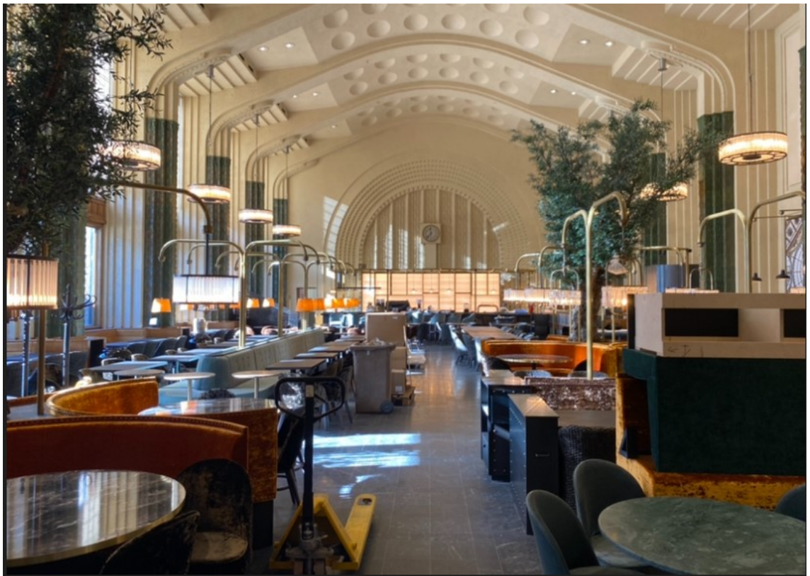
Kuva 31. Kuvassa ravintolan sähköasennukset valmiina.
