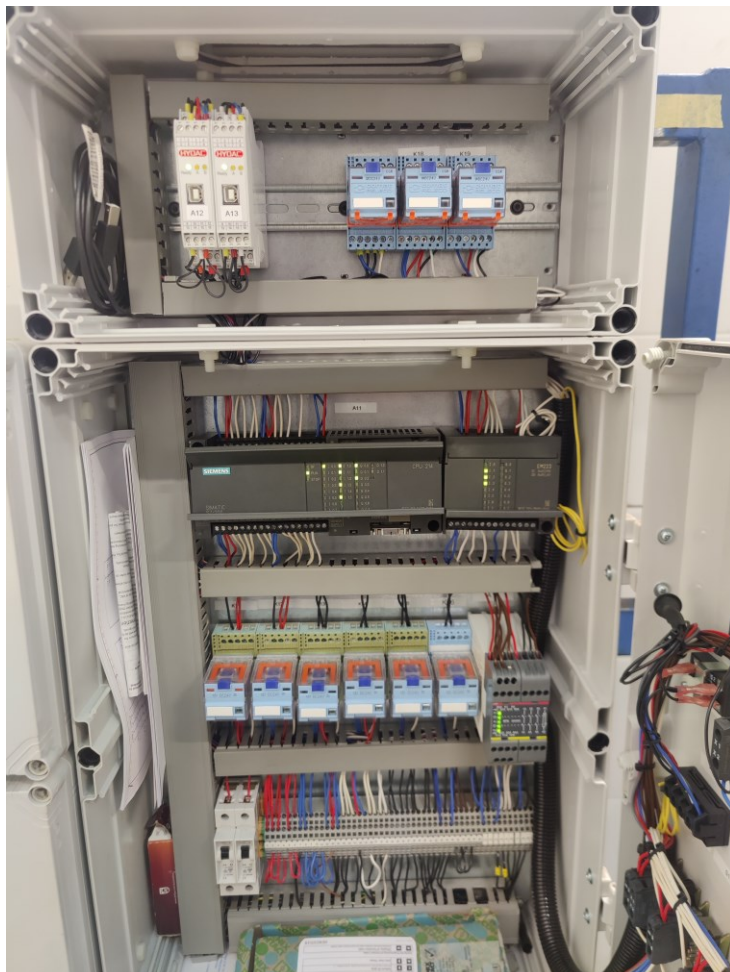
Kuva 21. Mastotesterin sähkökaappi, kuvassa keskellä Siemensin logiikkaohjain ja ylimpänä vasemmalla Hydacin tehovahvistimet.
