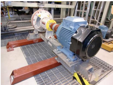
Kuva 15. Pumpun peti ja sähkömoottori
