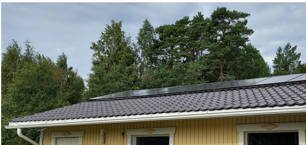
Kuva 7. Autotallin katolle asennetut aurinkosähköpaneelit.
