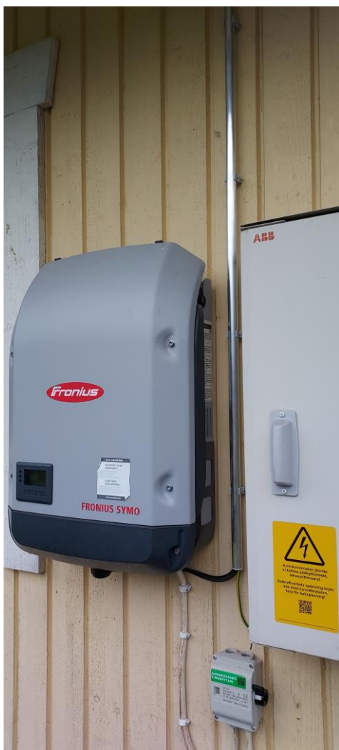
Kuva 8. Verkkoinverterti ja turvakytkin asennettuna sekä varoitustarra sähkökaapin ovessa.
