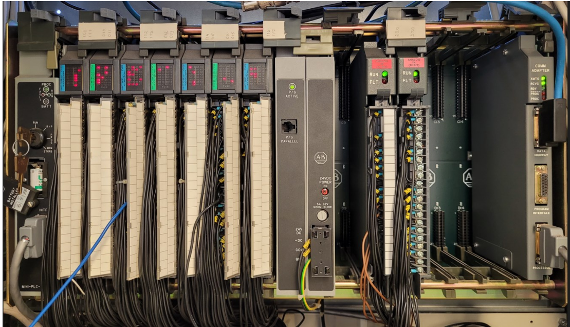
Kuva 2. Allen-Bradley PLC MINI 2/17 hardware
