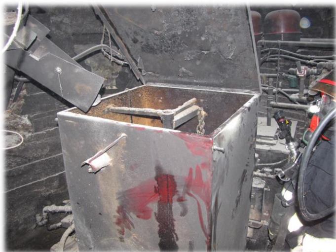
Kuva 10. Polttoainesäiliö jossa kansi teljetty auki. (Etelä-Pohjanmaan pelastuslaitos palontutkinta, i.a.).
