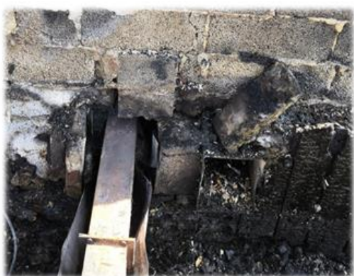
Kuva 18. Syöttöruuvien seinäläpivienti (Etelä-Pohjanmaan pelastuslaitos palontutkinta, i.a.).
