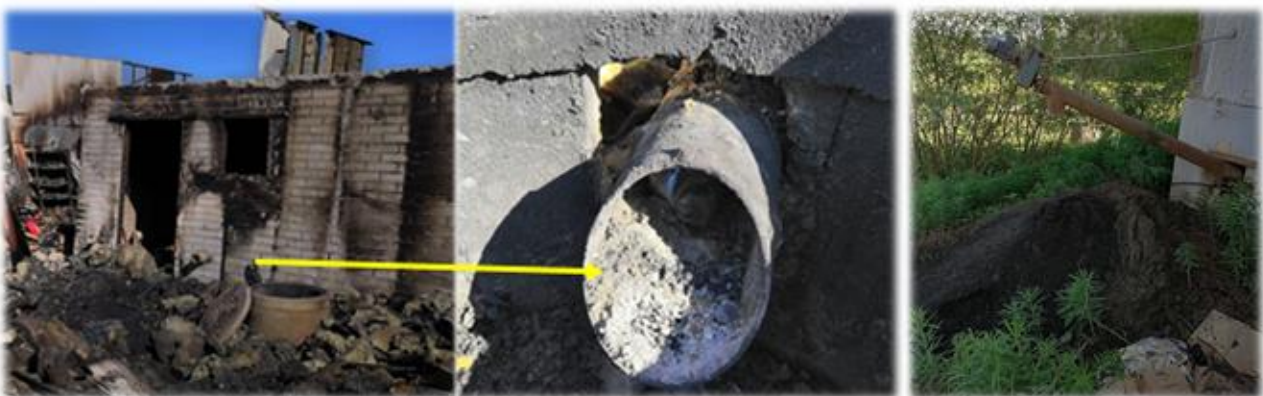
Kuva 17. Tuhkanpoiston puutteet (Etelä-Pohjanmaan pelastuslaitos palontutkinta, i.a.).
