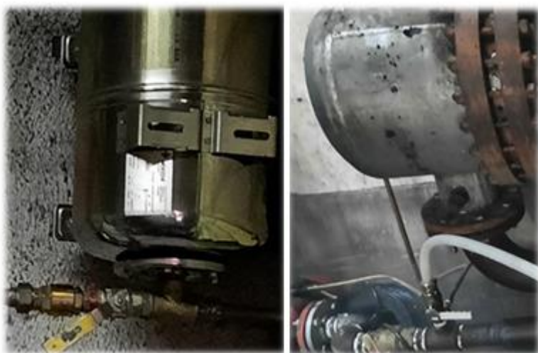
Kuva 14. Vesisammutusjärjestelmän vesihanoja (Etelä-Pohjanmaan pelastuslaitos palon- tutkinta, i.a.).
