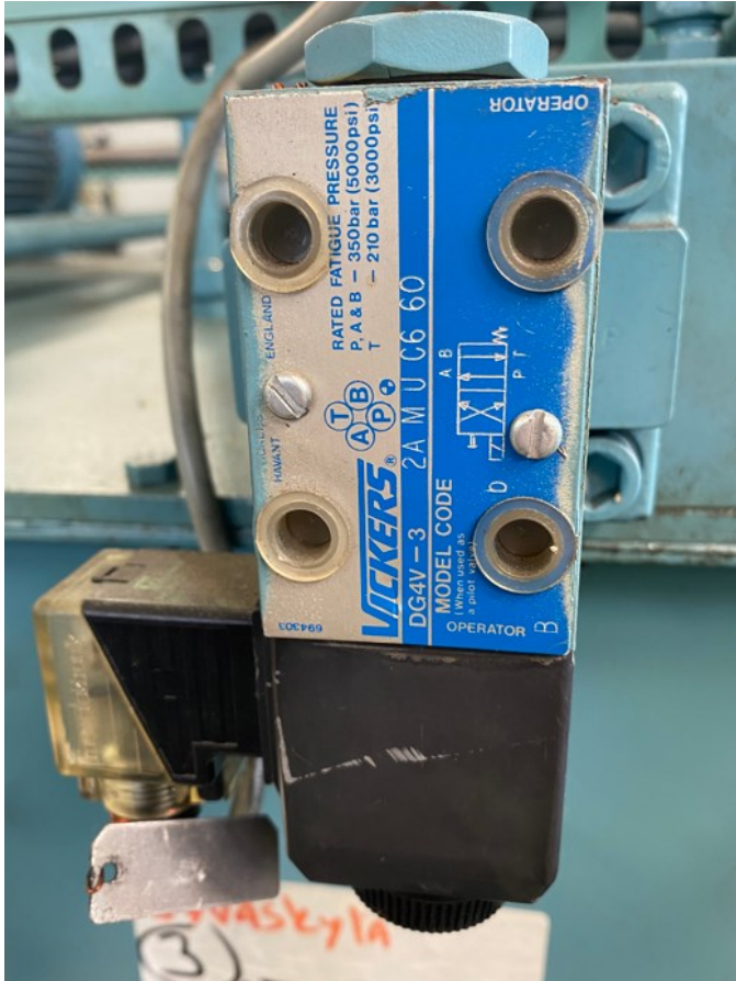
Kuva 16. Painelinjan sulkuventtiili ja kela.
