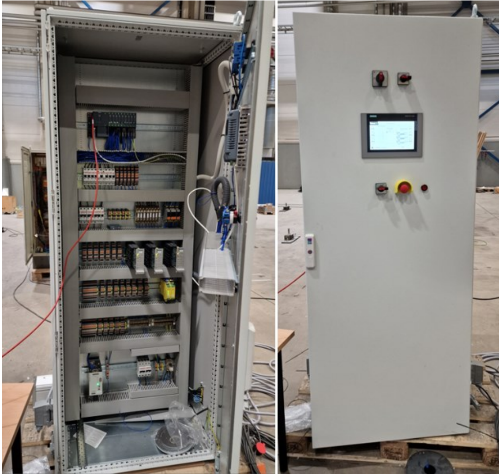
Kuva 21. Uusi ohjauskaappi koottuna.
