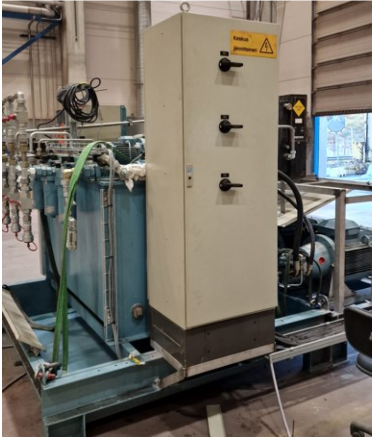
Kuva 6. MCC kiinnitettyä hydraulikkakoneikkoon.
