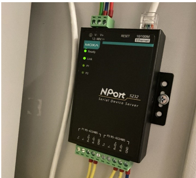
Kuva 19. Moxan Nport -sarjaporttipalvelin asennettuna.
