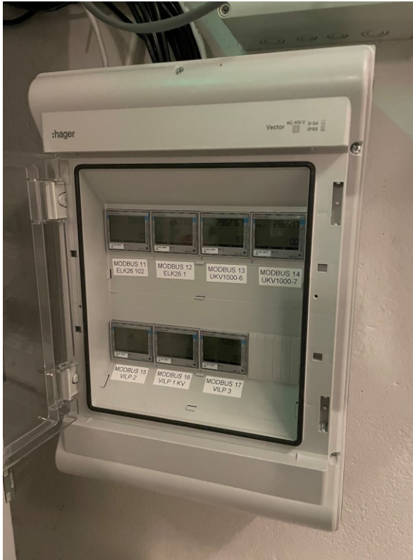
Kuva 15. Carlo Gavazzi EM330 Modbus -mittarit asennettuna.
