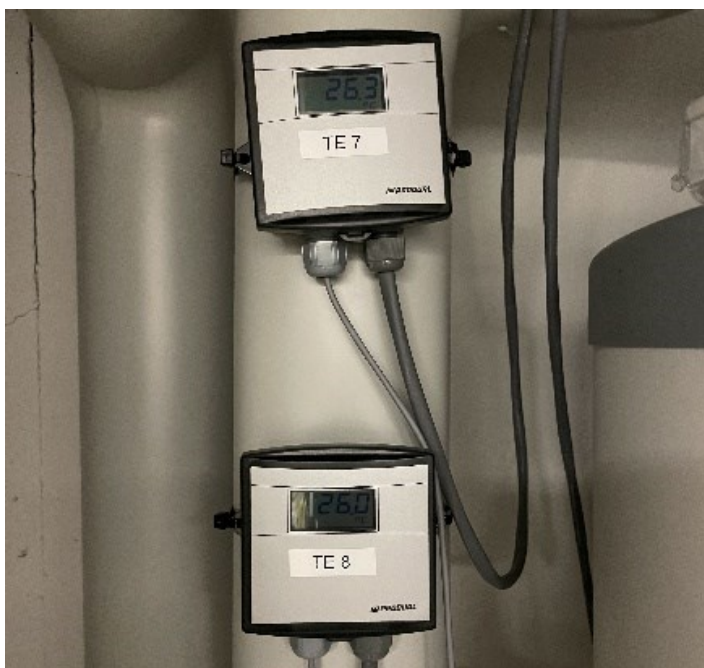
Kuva 17. Kaksi lämpötilalähetintä asennettuna ja kaapeloituna.
