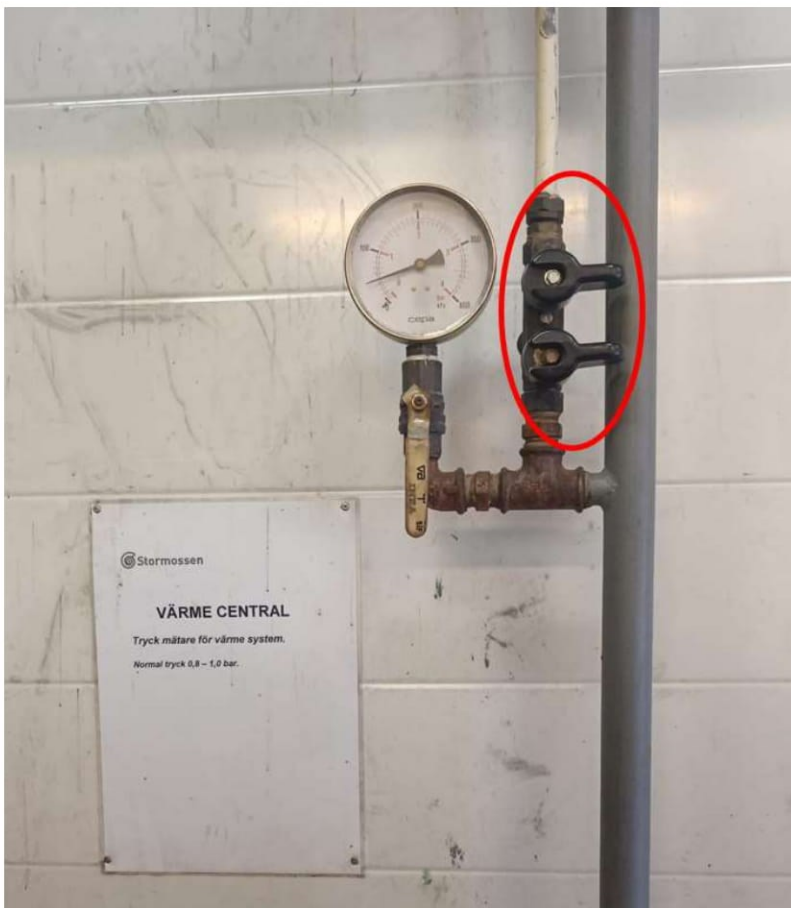
Figur 5 Påfyllningsventil till värmepannan i värmecentralen och dess tryckmätare.
