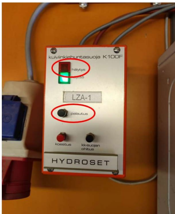
Figur 10 Torrkorningsskydd för värmepannan i Ammongas värmecentral.
