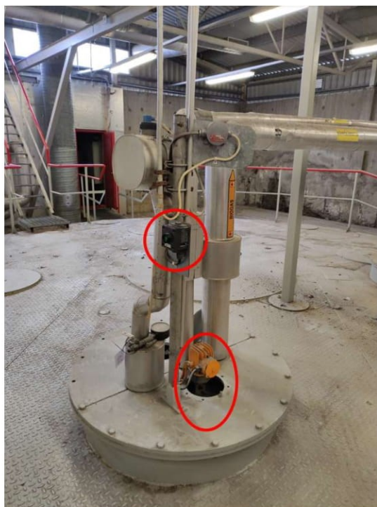
Figur 15 Fönster i reaktorn och lampknapp för att kontrollera nivån i BR1.
