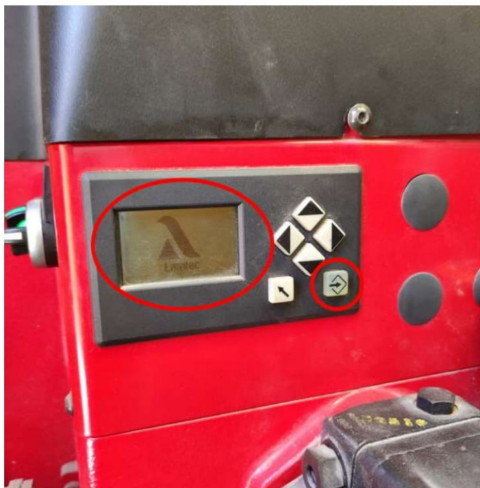
Figur 8 Skärmen på brännaren i Ammongas värmecentral och knappen som blinkar rött vid fel.
