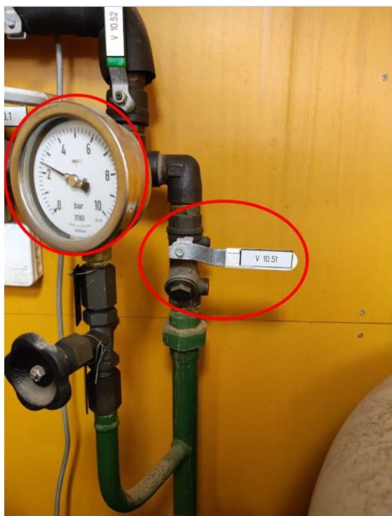
Figur 9 Påfyllningsventil (V 10.51) till värmepannan i Ammongas värmecentral och dess tryckmätare.
