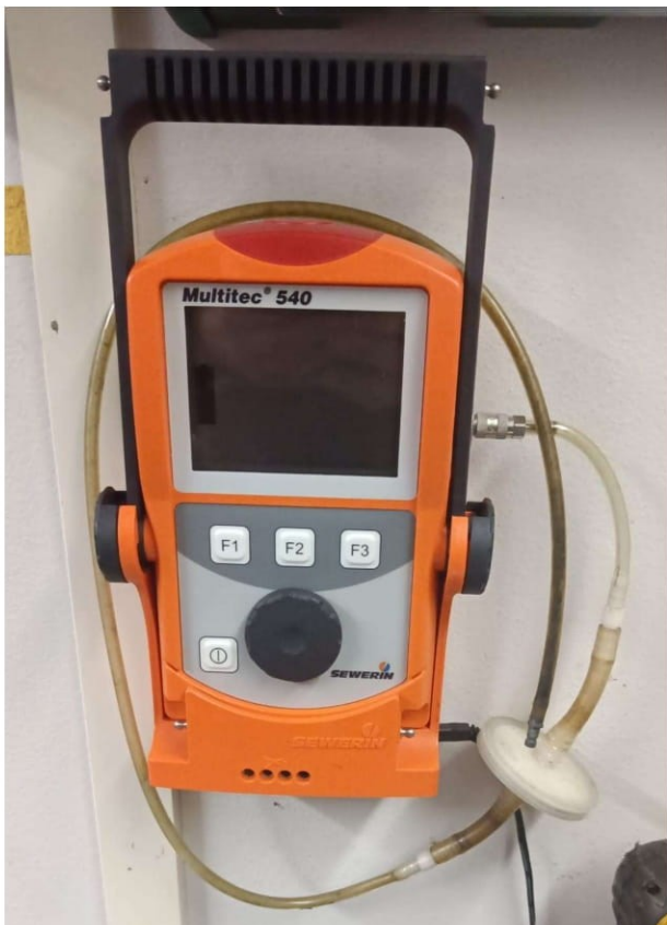
Figur 3 Metanhalts mätare. Finns på väggen i kontrollrummet på biosidan.
