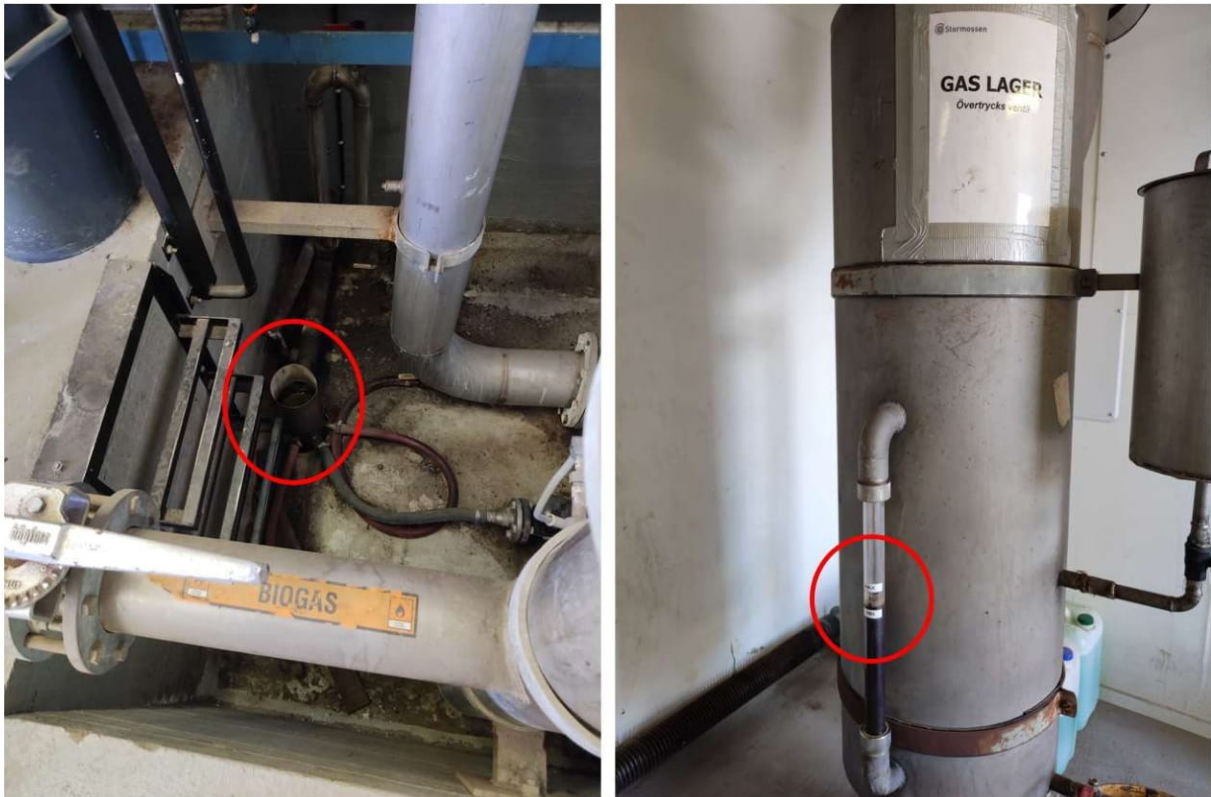
Figur 2 kondensvatten utloppsörret från gaslagret (golvbrunnen) och gaslagrets övertrycksventil
