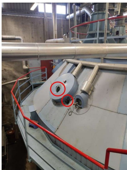
Figur 16 Fönster i reaktorn och lampknapp för att kontrollera nivån i BR2.
