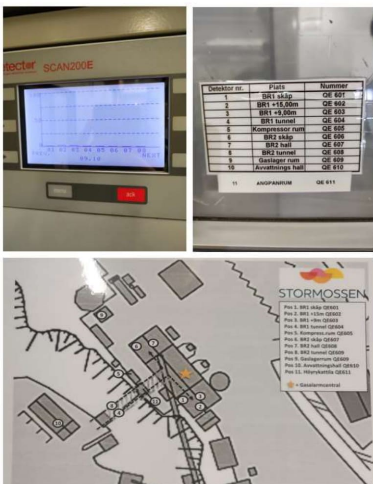
Figur 1 Skärm på gasalarmcentral samt lista och karta över var gasdetektorerna är placerade.
