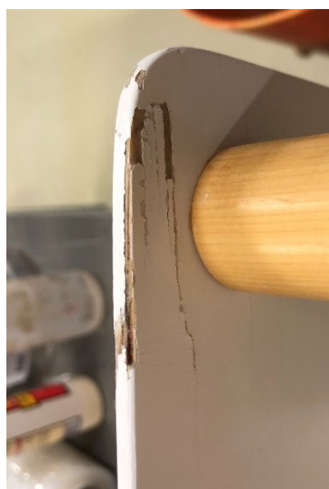
Kuva 45. Halkeama ennen toimenpiteitä
