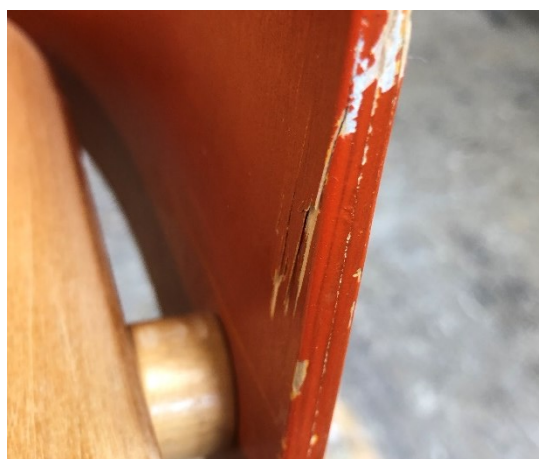
Kuva 38. Vaurio vanerin pintaviilussa
