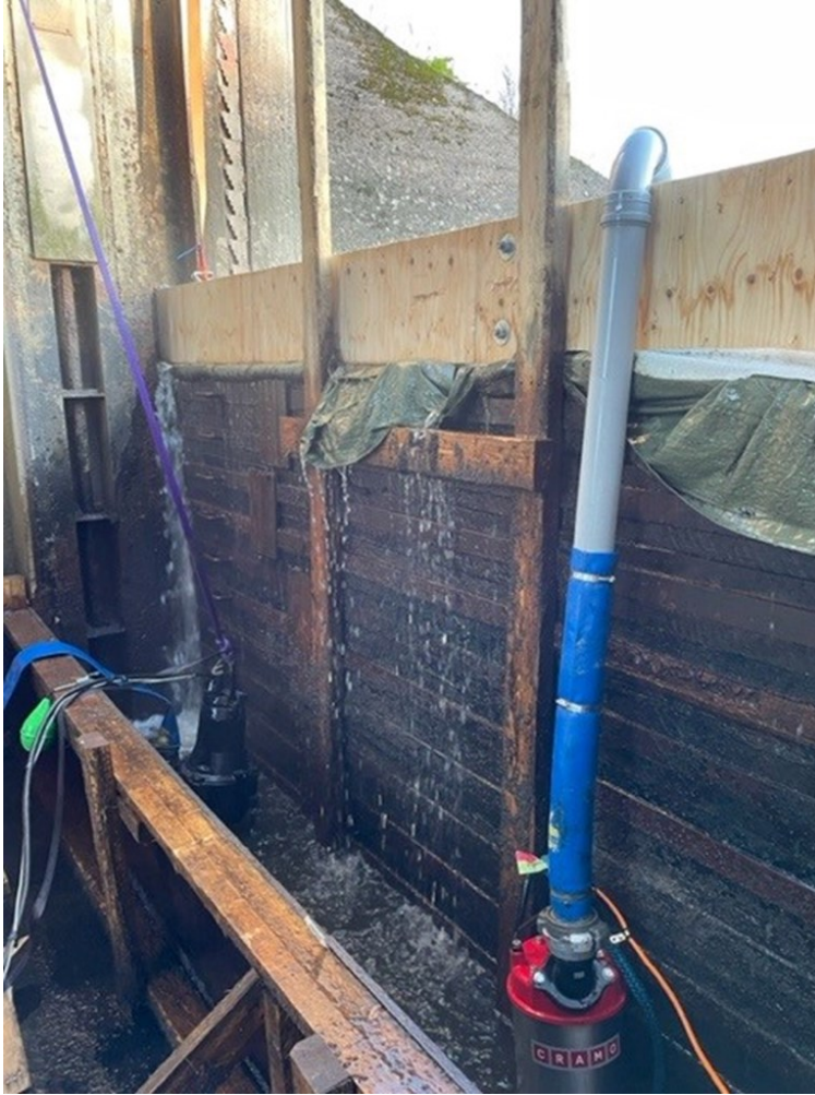
Kuva 9. Kaukaloon sijoitettu uppopumppu, joka pumppaa veden padon yläpuoliseen altaaseen.
