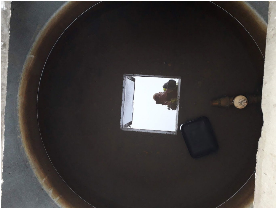
Kuva 7. Yksi Pitkäjärven suodatinjärjestelmän biohiili-sepeliseosta sisältävistä suodatinkaivoista, joka on padottanut syksystä 2021 lähtien. Kuvassa oikealla näkyvä tuloputki tulisi olla veden yläpuolella, mutta koska suodatinmateriaali on tukkeutunut, ei vettä pääse poistumaan samaa tahtia kuin sitä virtaa kaivoon (kuva: Aki Mykkänen).
