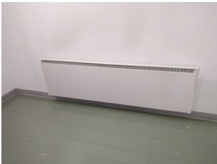
Kuva 4. Sähköpatteri yhdessä kohteessa porraskäytävässä.
