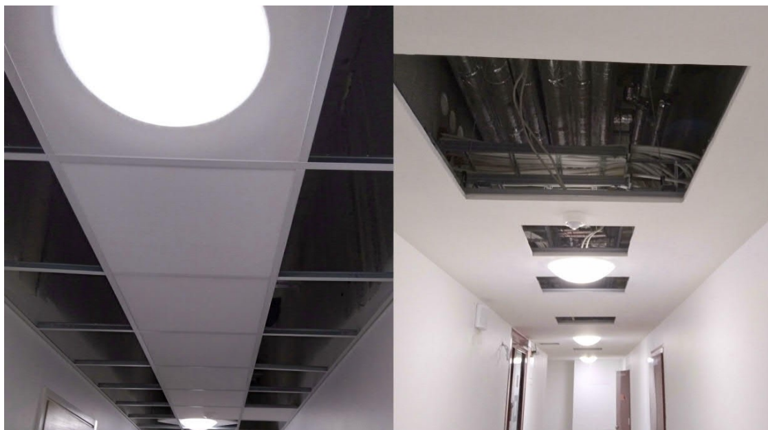
KUVA 7. Vasemmalla pala-alakatto, joka ei täytä palo-osastoinnin määräyksiä. Oikealla kipsilevyistä tehty paloalakatto, johon on asentamatta palonkestävät tarkastusluukut (Laine 2022).
