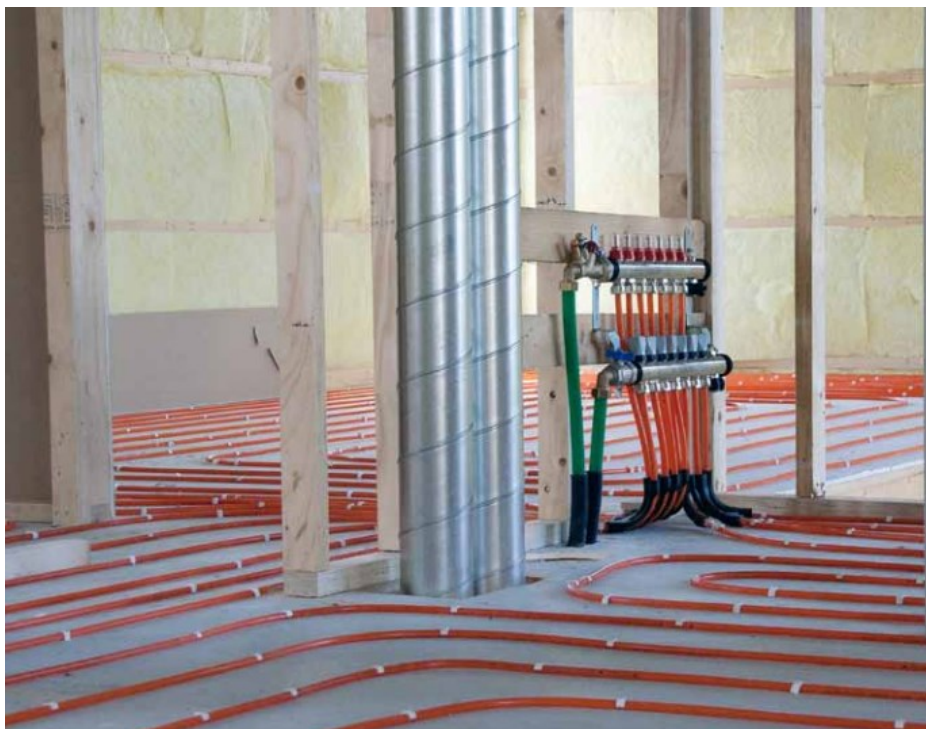
Kuva 7. Lattialämmitysputkisto ja jakotukit (MuoviTech 2022, 12)
