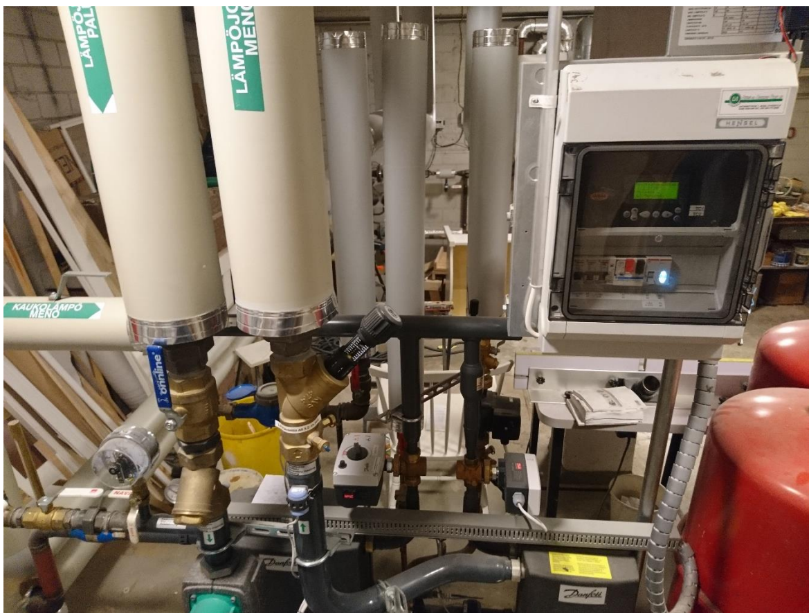
Kuva 2. Saihokatu 3:n kaukolämpölaitteiston mittaristo ja lämmönjakokeskus
