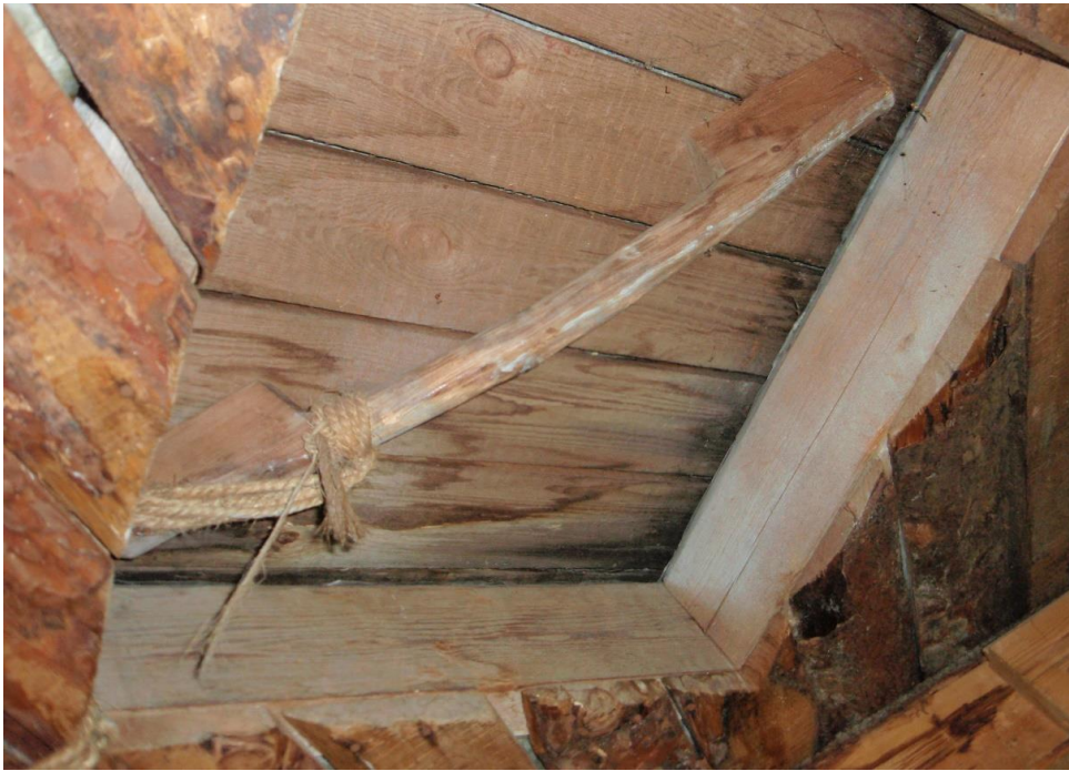
Kuvio 16. Kattoluukun lahoamisvaurio.
