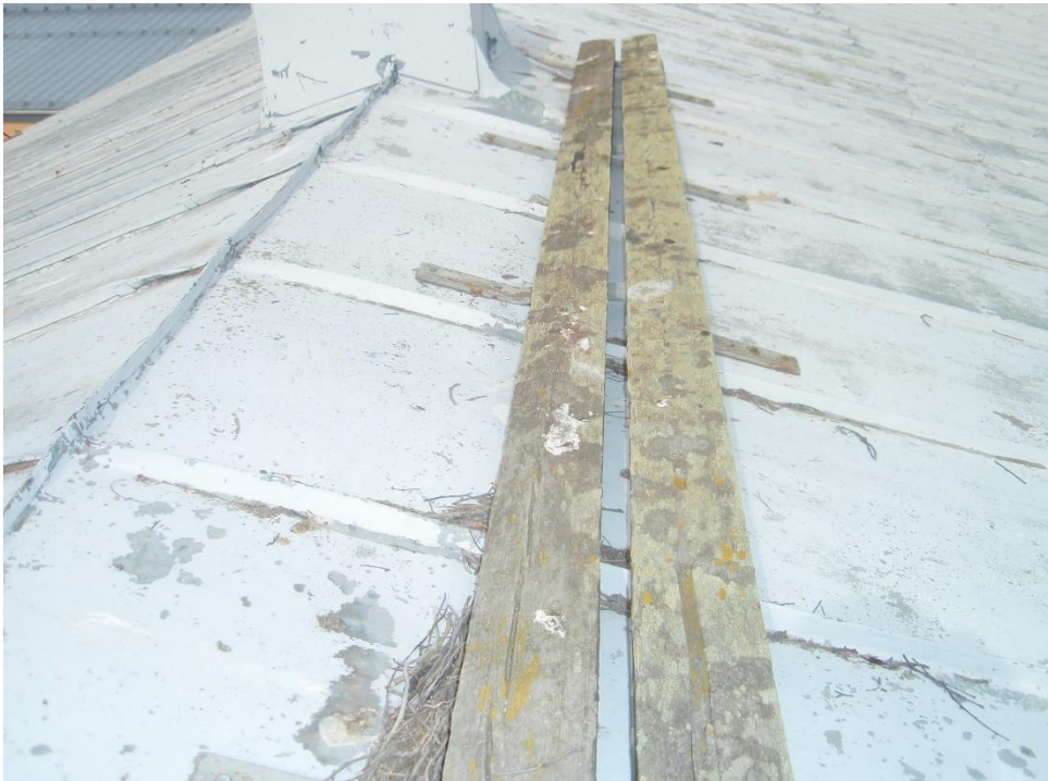
Kuvio 17. Peltivesikate on kulunut ja kulkusillat ovat lahonneet.
