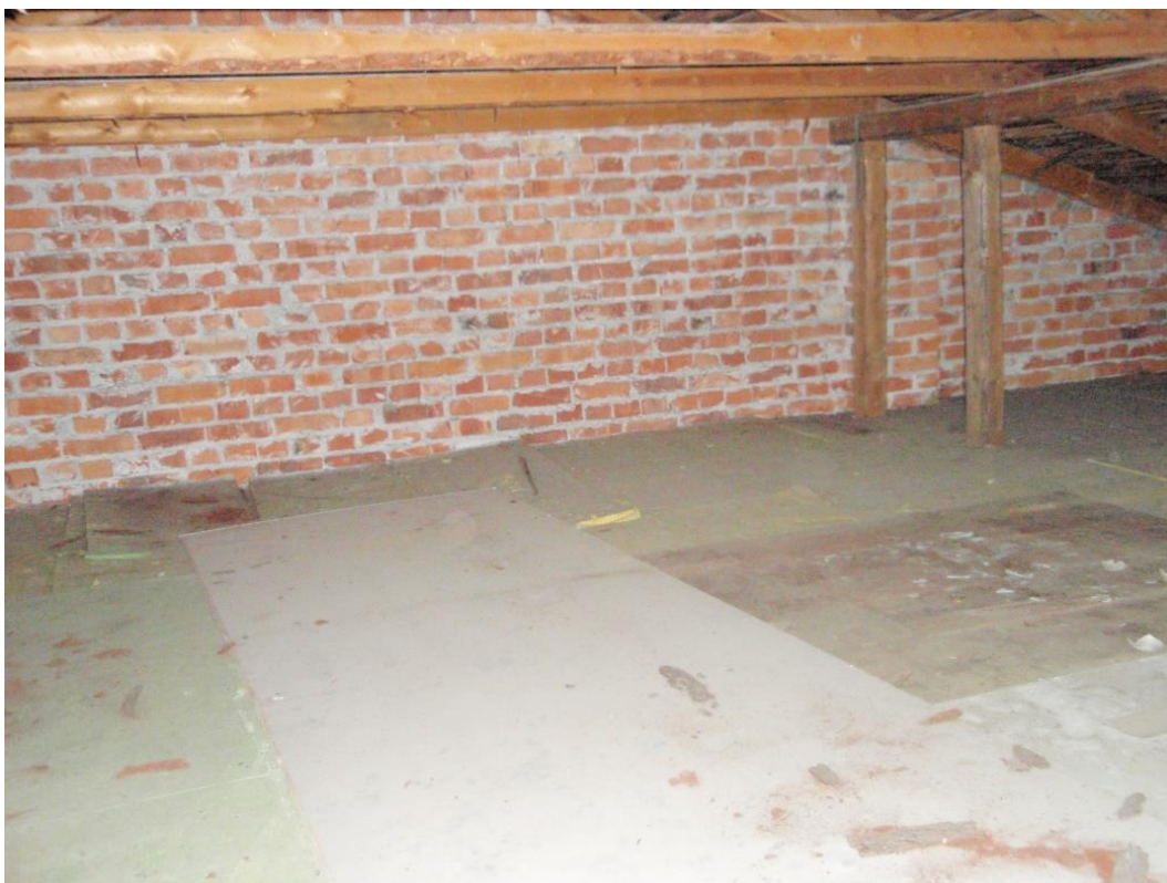
Kuvio 15. Ullakkotilan päädyistä puuttuvat tuuletusaukot. Eristeiden päällä säilytetään myös ylimääräistä tavaraa.
