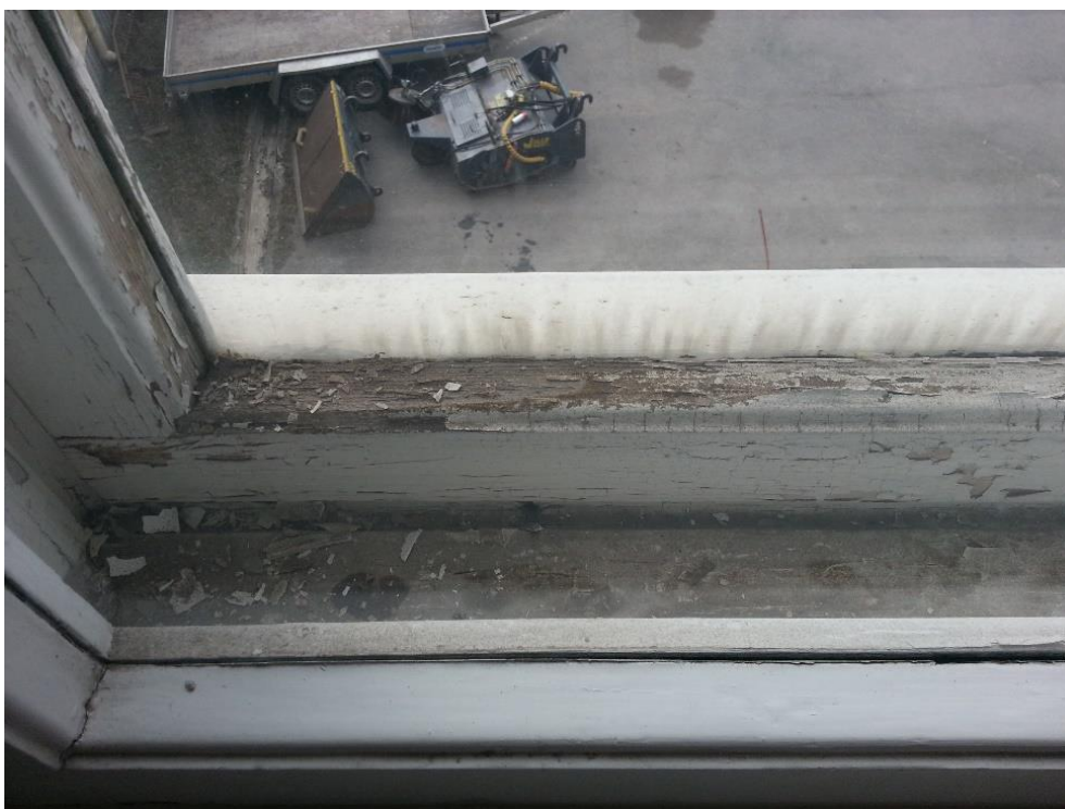
Kuvio 13. Lasituskittaukset ovat kuluneet ja ulkopuitteessa on lahoamista.
