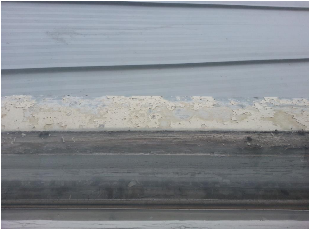
Kuvio 10. Ikkunapellin ja ulkopuitteen vaurioita.
