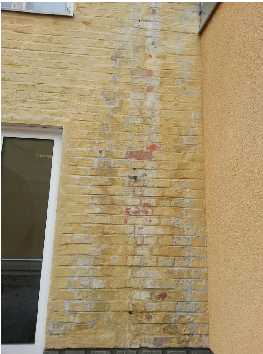
Kuvio 9. Rapautunutta rappausta rakennuksen itäsivulta.
