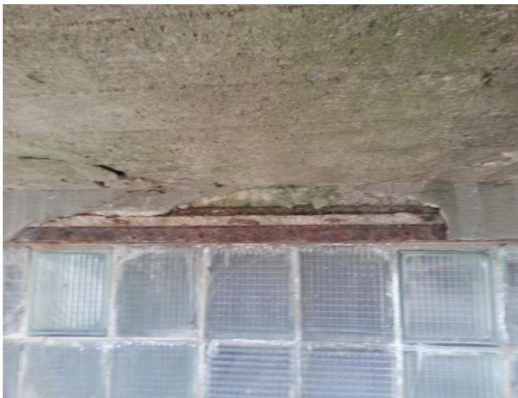
Kuvio 4. Korroosioaurio sokkelissa.
