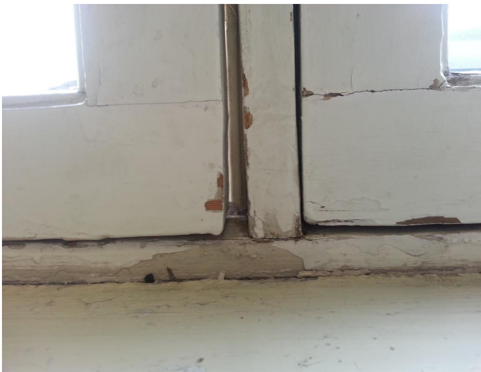
Kuvio 12. Ikkunakarmin ja -puitteiden välinen suuri rako.
