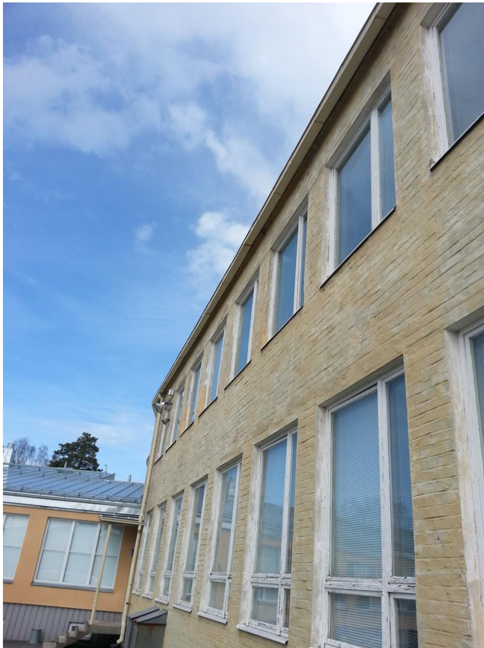
Kuvio 8. Julkisivurappauksen kunto länteen.
