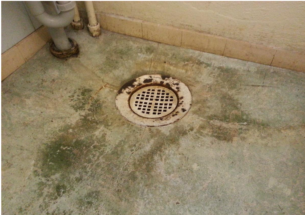
Kuvio 6. Kellarikerroksen pukuhuoneen kosteusvuoto.
