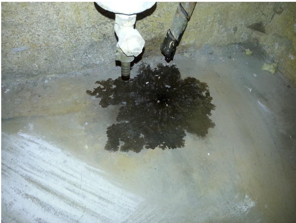
Kuvio 5. Kosteusvuoto teknisessä huoneessa U039.
