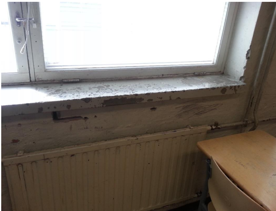
Kuvio 20. Ikkunapenkkien ja ulkoseinien sisäpinnan vauriota.
