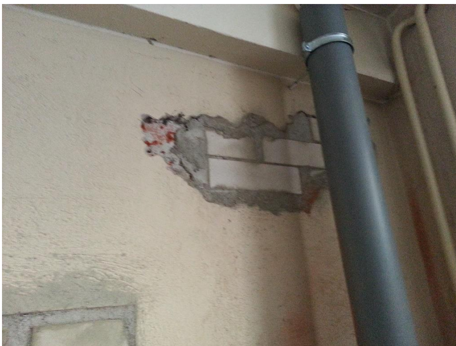
Kuvio 19. Kellarin varaston väliseinää oli avattu ilmeisesti tarkoituksella.
