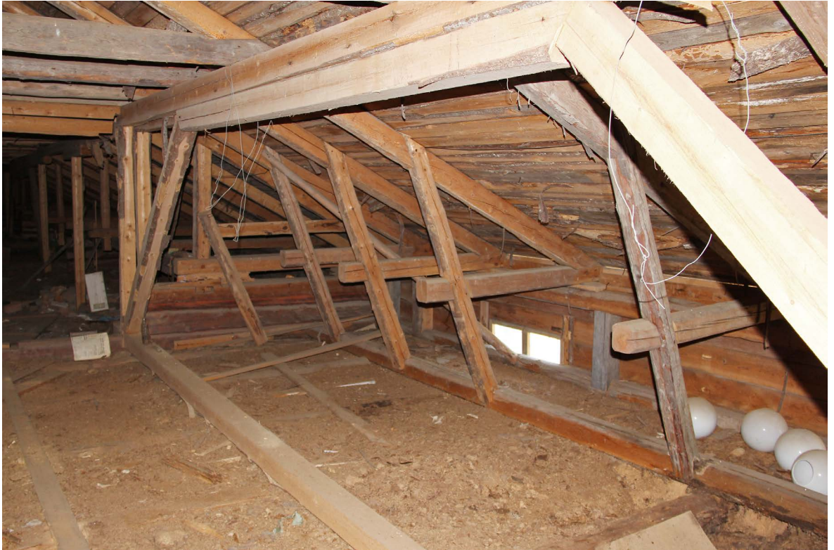
Kuva 9. Päärakennuksen vuoden 1907 laajennusosan kattotuolit. Kuvassa näkyy nuorempi versio ruotsalaisesta kattotuolista. Kuvan etualalla olevat vaaleammat parrut on lisätty jälkikäteen. Huopakatteen jälkeen tullut betonitiili on vaatinut lisää kannatinrakenteita entisten rinnalle. Kuva: Ville-Matti Rautjoki.
