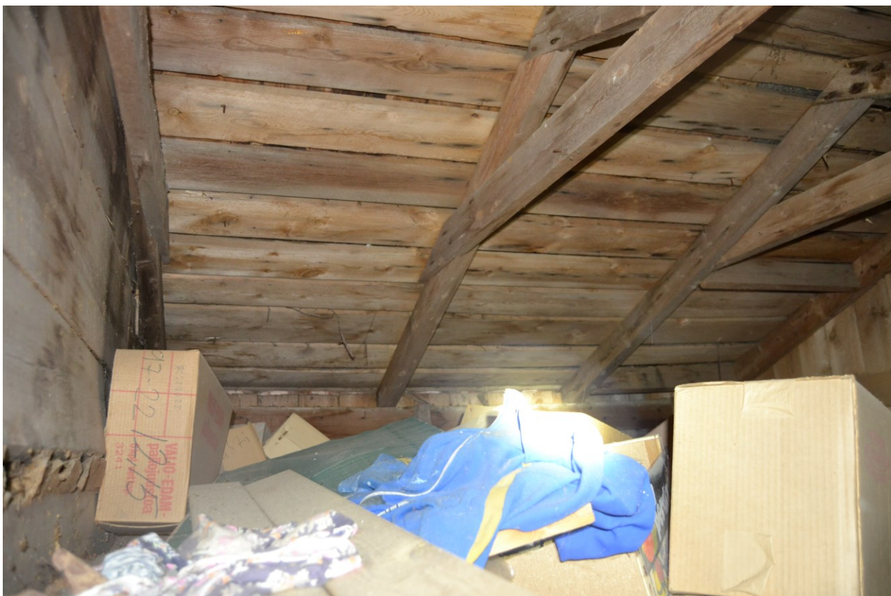
KUVA 43. Vesikatteen alustaa kuistin katon kohdalla. Kosteudesta aiheutuneita jälkiä havaittiin jonkin verran. (Heikkinen 2022).
