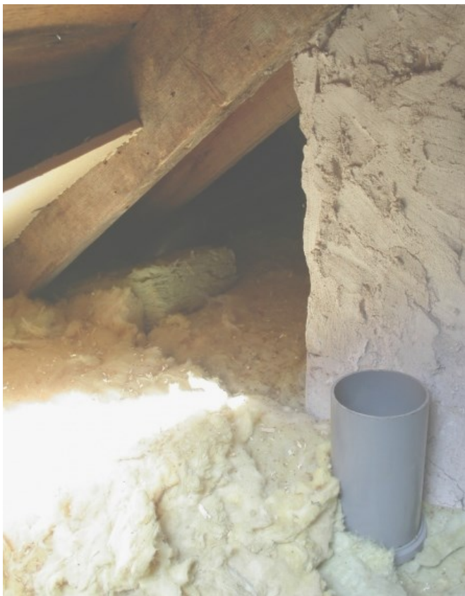
KUVA 21. Kuvaleike. Yläpohjan tuuletustilaan päättyvä viemärin tuuletusputki voi osaltaan saada aikaan kosteusvauriota. (Hometalkoot 2016.)
