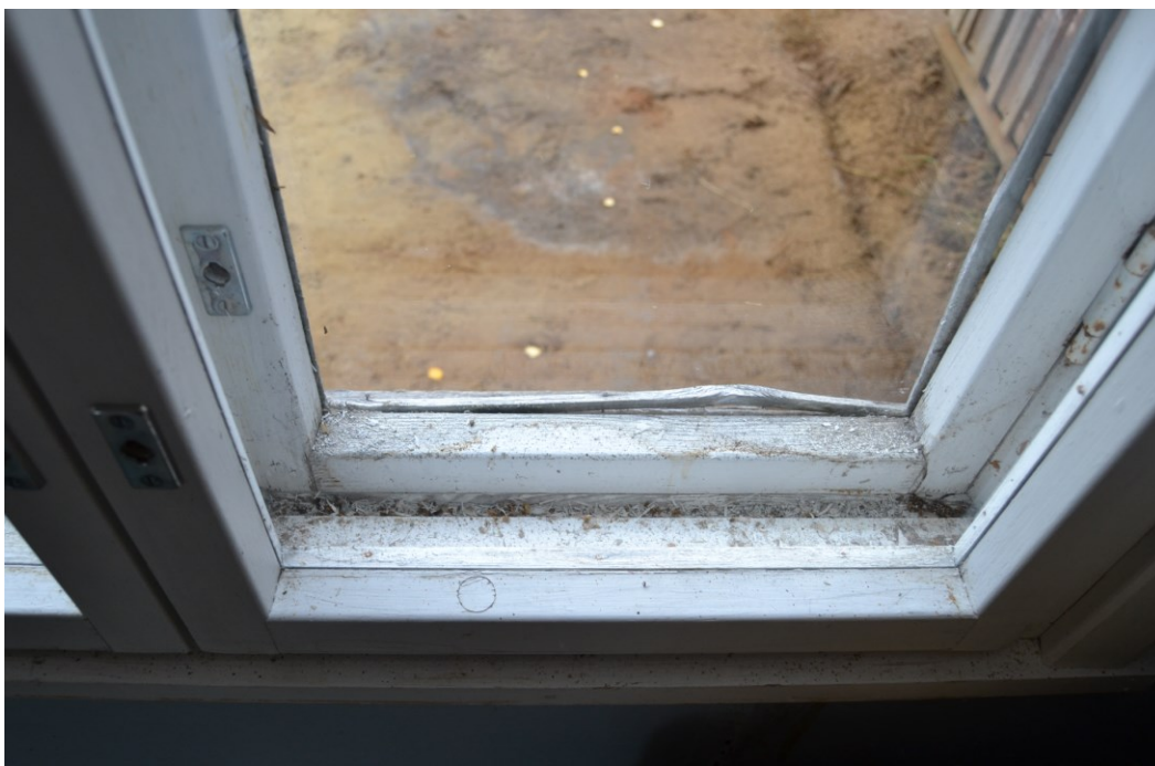
KUVA 24. Maalia hilseillyt ikkunan sisään (Heikkinen 2022)
