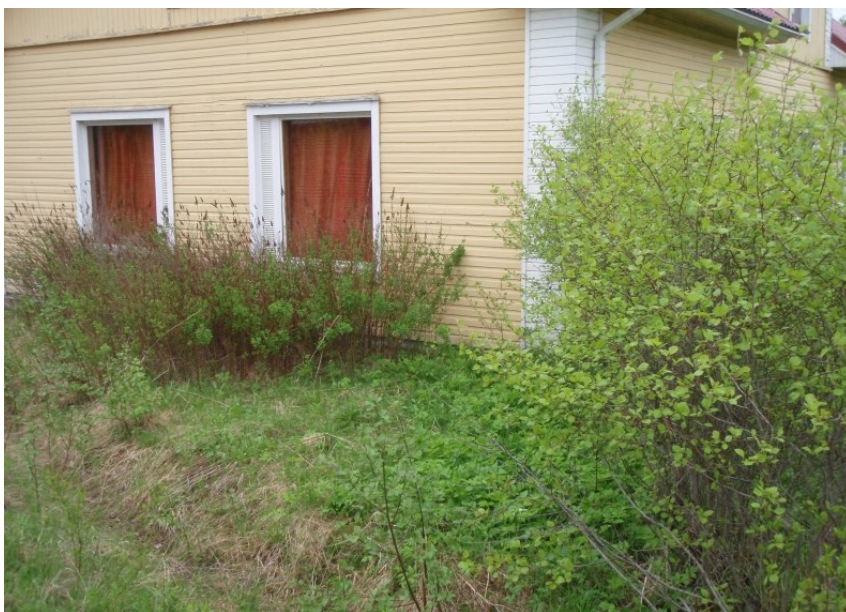
KUVA 5. Kuvaleike. Kuvaesimerkki; talon vierustalla kasvaa pensaat ja ne estävät julkisivun tuulettumisen (Hometalkoot 2016.)
