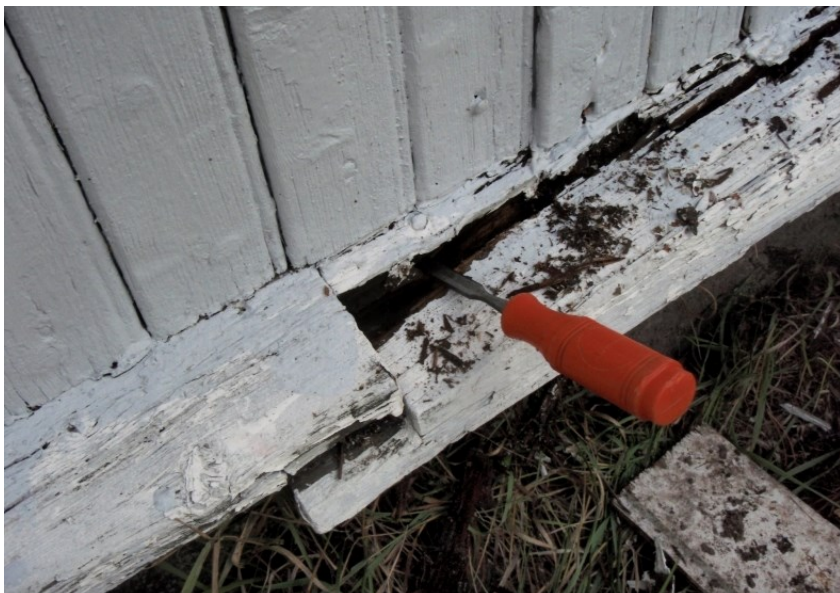
KUVA 6. Kuvaleike. Kuvaesimerkki siitä, kun julkisivulaudoitus ja sen alapuolella oleva muotolista ovat lahonneet laudoituksen takaa kokonaan puuttuvan tuuletusraon vuoksi (Hometalkoot 2016.)
