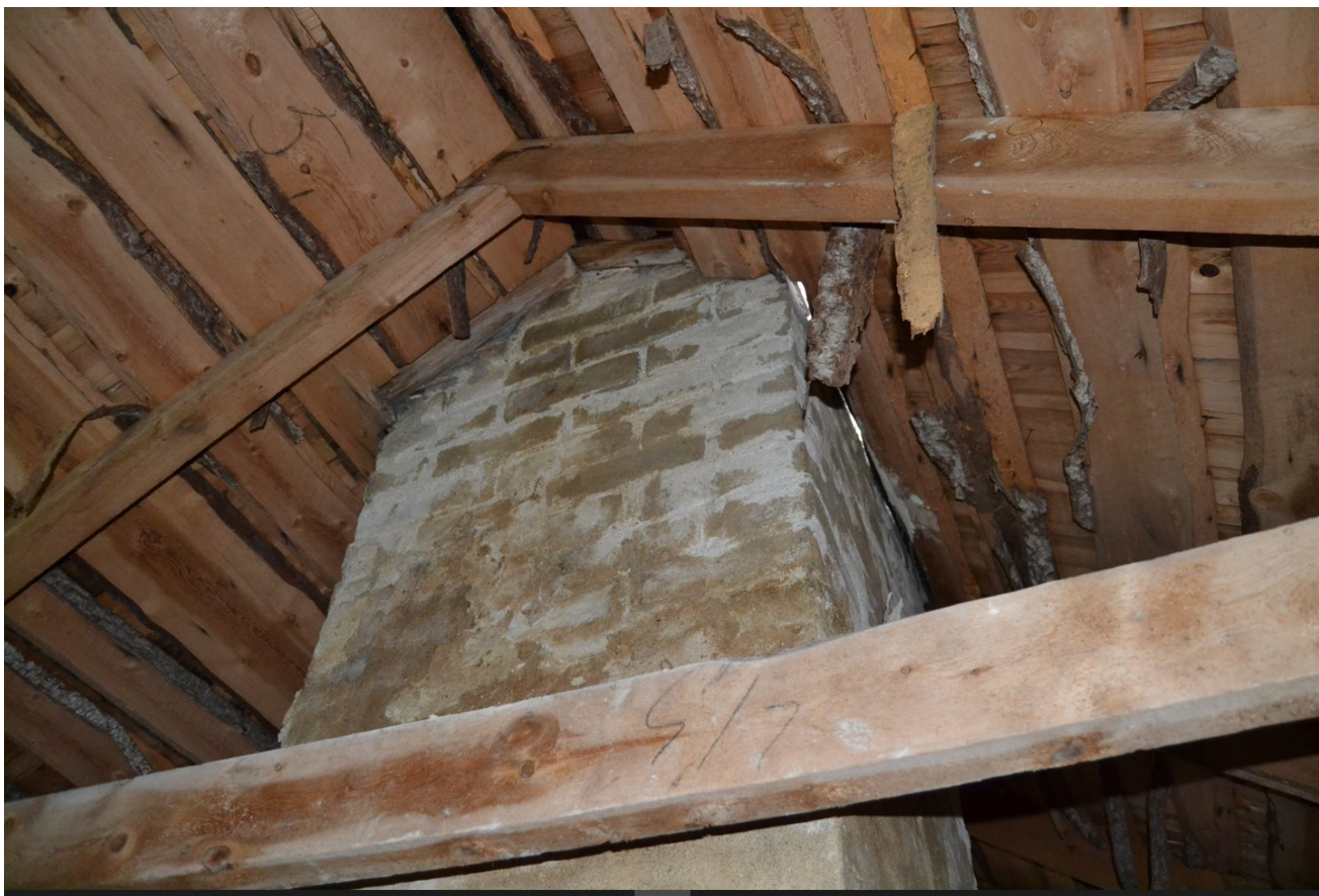
KUVA 41. Hormin ja vesikatteen läpivienti, osin näkyy päivänvaloa sisälle. Hormia ympäröivissä puurakenteissa on vaaleita merkkejä kosteuden vaikutuksista, vaikka tarkasteluajankohdalla ei akuuttia vuotoa havaittukaan. (Heikkinen 2022).
