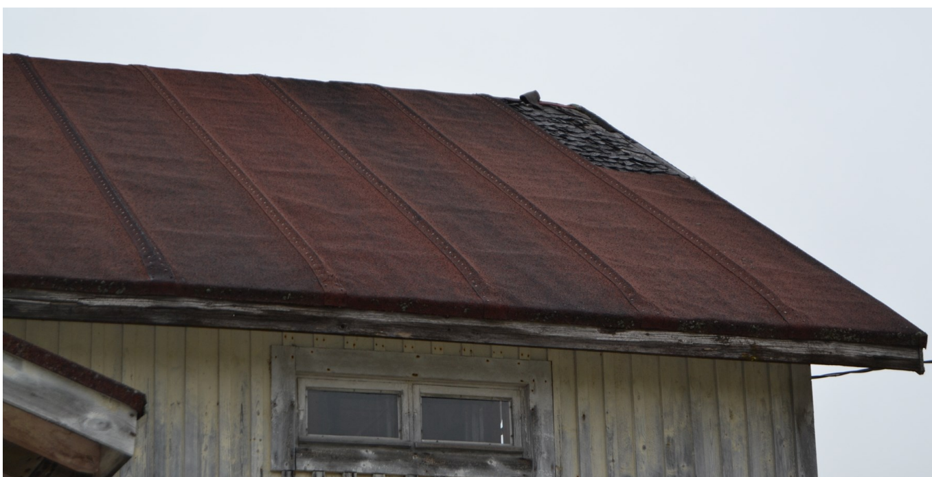
KUVA 45. Huopakatteen isoin vauriokohta. Alkuperäistä pärekatetta näkyy alta (Heikkinen 2022)
