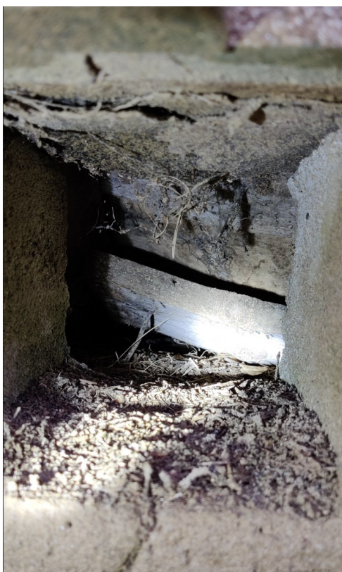
KUVA 18. Kuva talon etuosasta oikean tuuletusaukon kohdalta. Alapohjarakenteita romahtanut ja tuuletuskin näin estyy (Heikkinen 2022).
