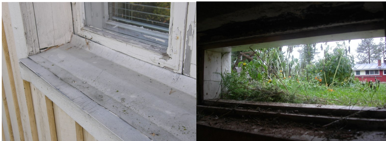
KUVA 18. Kuvaleike. Vasemmalla esimerkki kehnosta ja huonosti toimivasta ikkunanpellityksestä. Oikealla esimerkki kellarin puuikkunasta, joka on aivan maan tasolla. (Hometalkoot 2016.)
