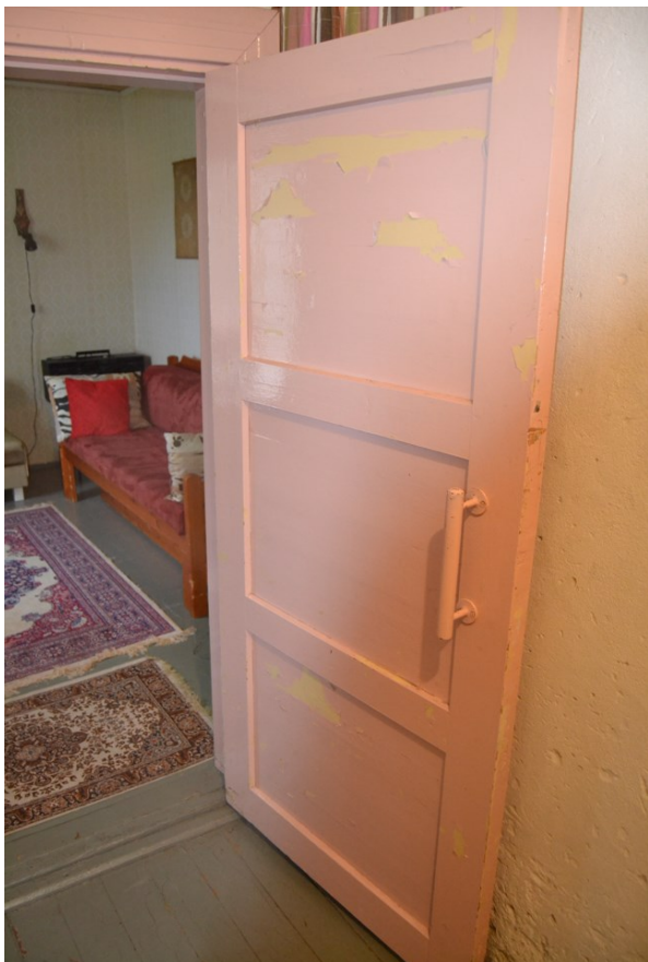
KUVA 29. Sisäovissa on maalivaurioita (Heikkinen 2022)
