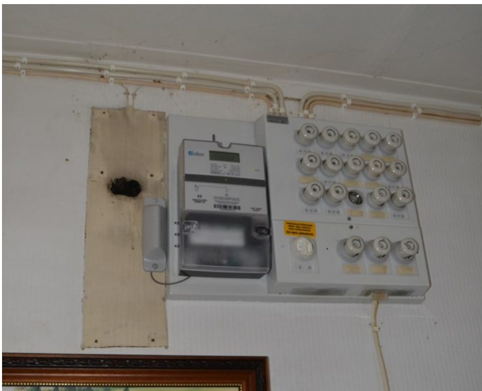
KUVA 47. Sähkötaulua ja mittaristoa (Heikkinen 2022)
