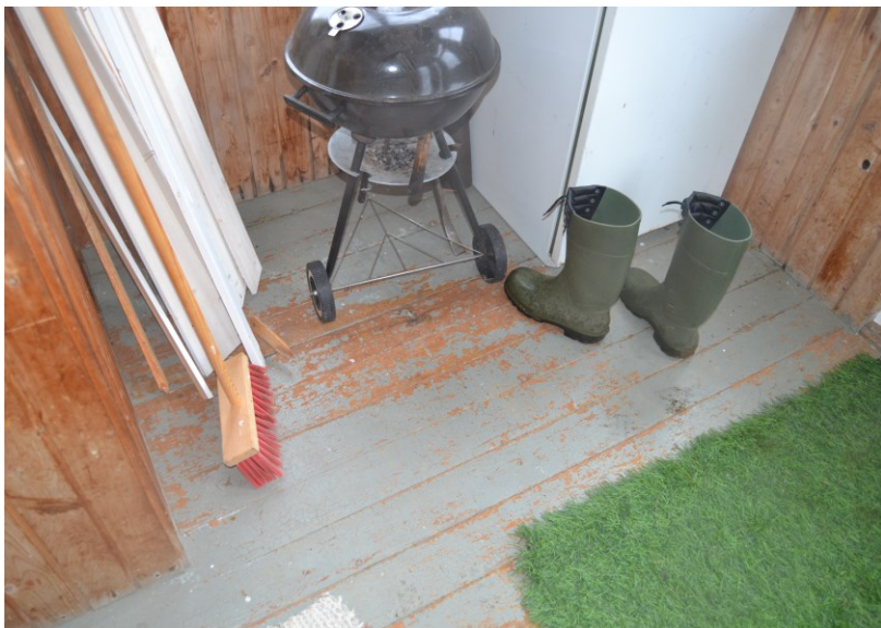
KUVA 33. Kuistin lattia on sisätilan kulunein (Heikkinen 2022)
