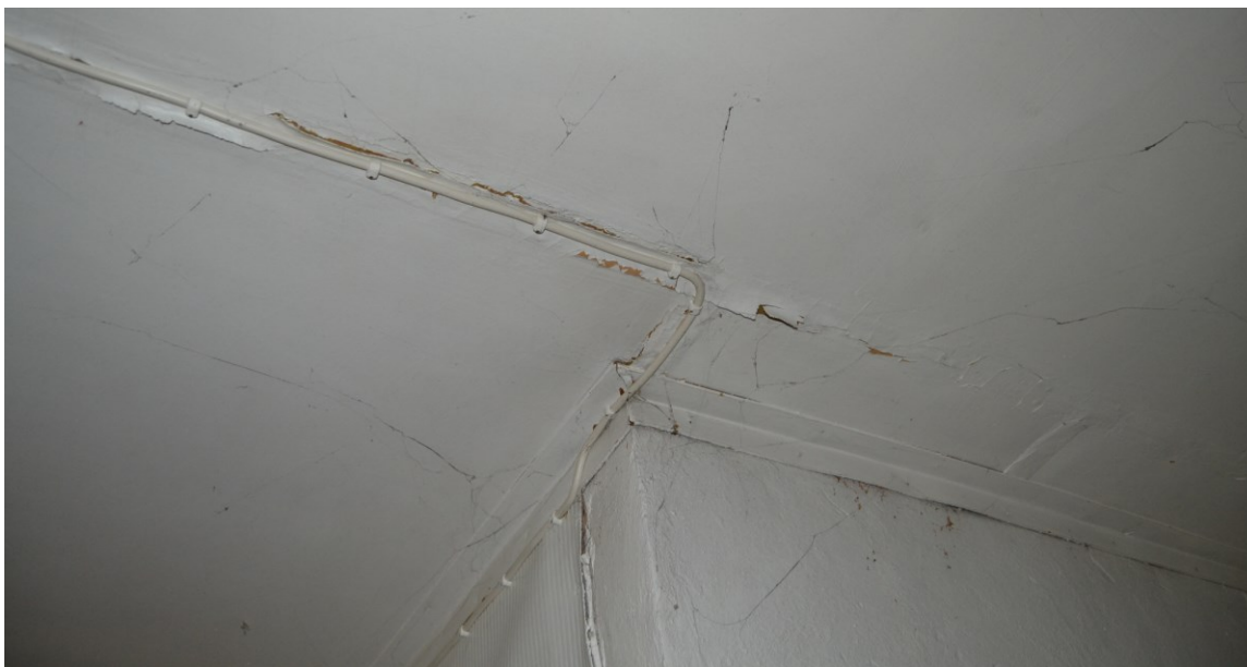
KUVA 32. Esimerkki sisäkaton pintavaurioista tuvassa (Heikkinen 2022)
