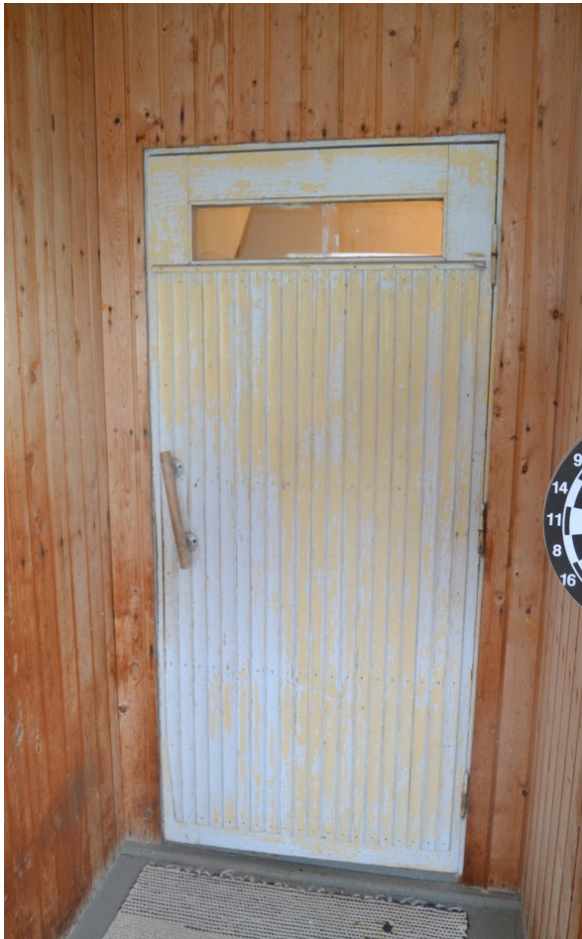
KUVA 28. Eteisen sisäovi, maalivauriota (Heikkinen 2022)
