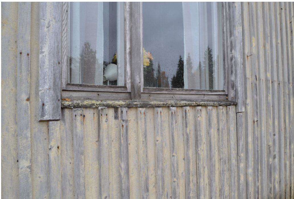
KUVA 23. Kuva sammalvauriosta, jota ajan myötä on ikkunan alalautaan muodostunut (Heikkinen 2022).
