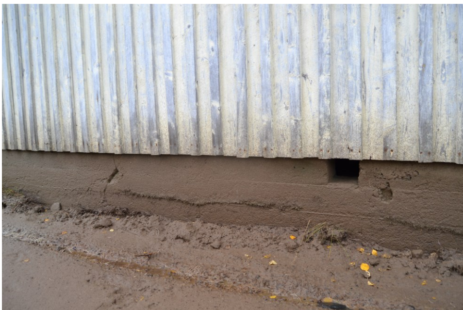
KUVA 16. Esimerkki vauriosta sokkelissa (Heikkinen 2022)
