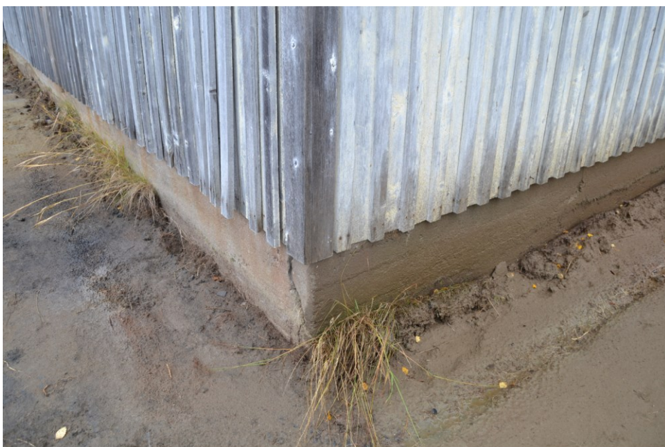
KUVA 15. Esimerkki vauriosta sokkelissa (Heikkinen 2022)
