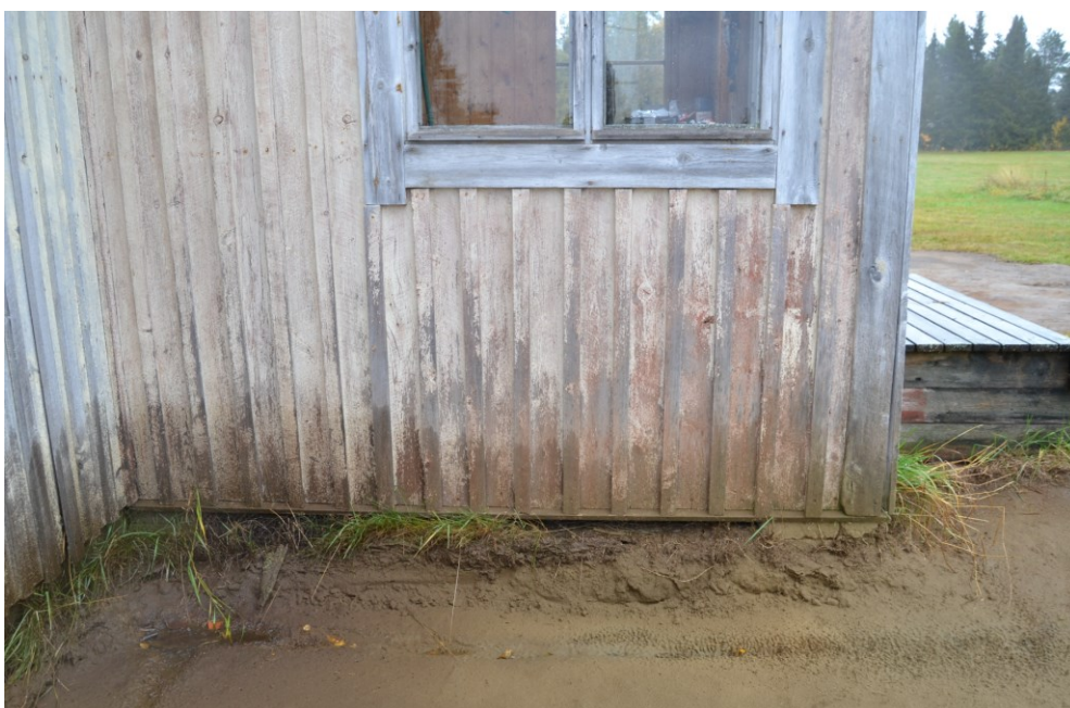
KUVA 11. Maanpinta on liian lähellä puurakenteita ainakin kuistin osalta (Heikkinen 2022).
