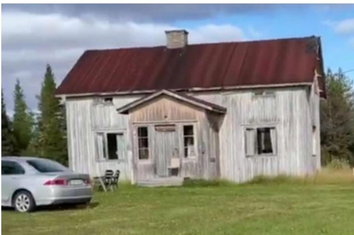
KUVA 9. Havainnollistava kuva kesältä 2022 ennen vierusmaiden muokkausta. Ulkoverhouslaudat ovat aivan maan tuntumassa (Ketola 2022).
