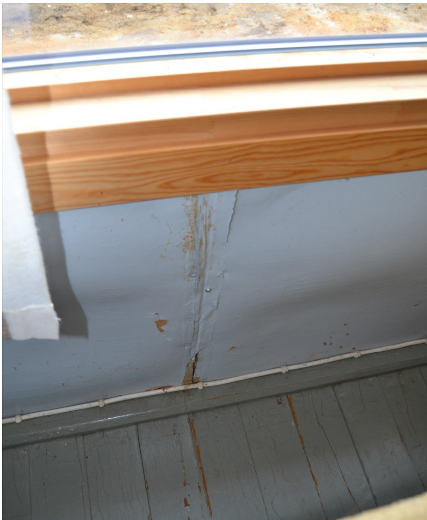
KUVA 31. Esimerkki seinäpahvien liitoksen vauriosta sekä samassa kuvassa lattian maalipinnan kuntoa (Heikkinen 2022).
