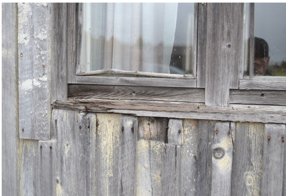
KUVA 22. Kuvassa ikkunan alalaudan vaurioitumista/lahoamista (Heikkinen 2022)
