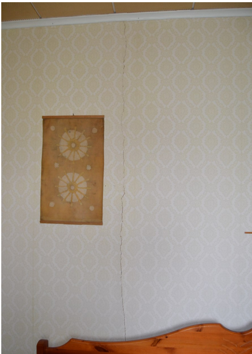
KUVA 34. Halkeama tapetissa seinän elämisestä 1. makuukamarissa (Heikkinen 2022)
