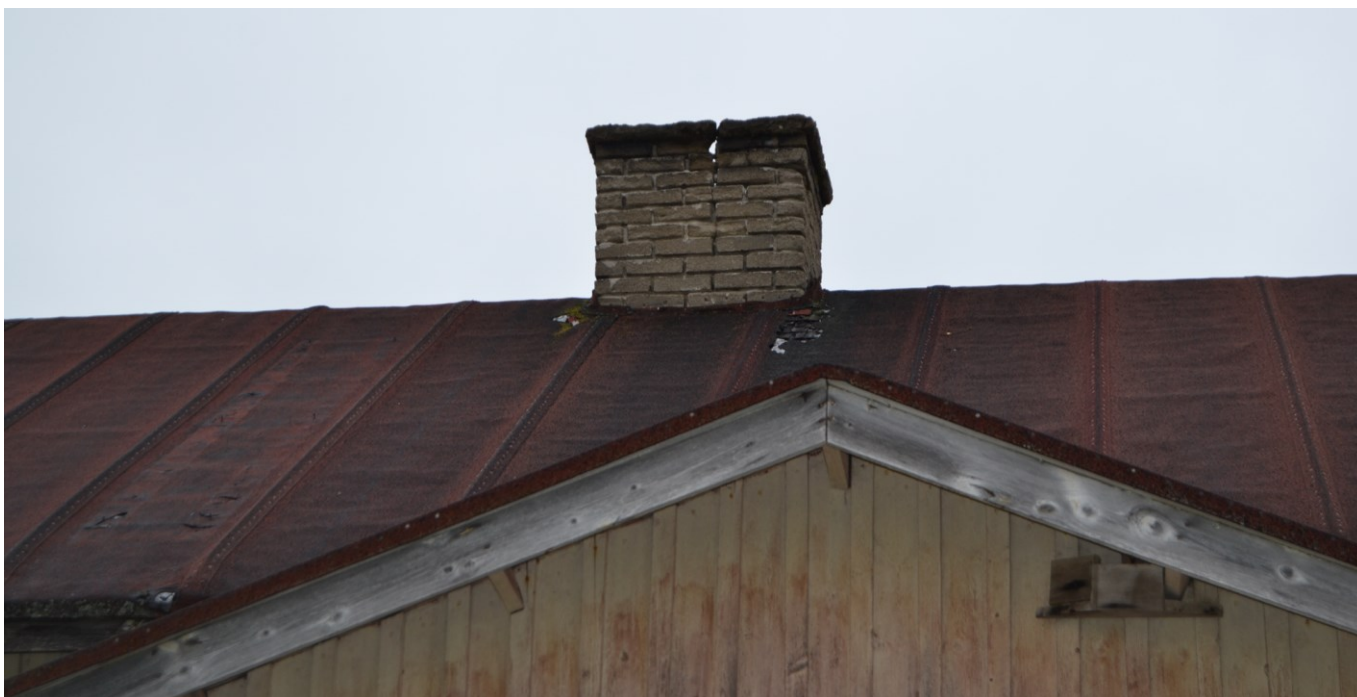
KUVA 44. Kuvassa savupiippua/hormia ulkopuolelta sekä huopakatteen vauriota (Heikkinen 2022)
