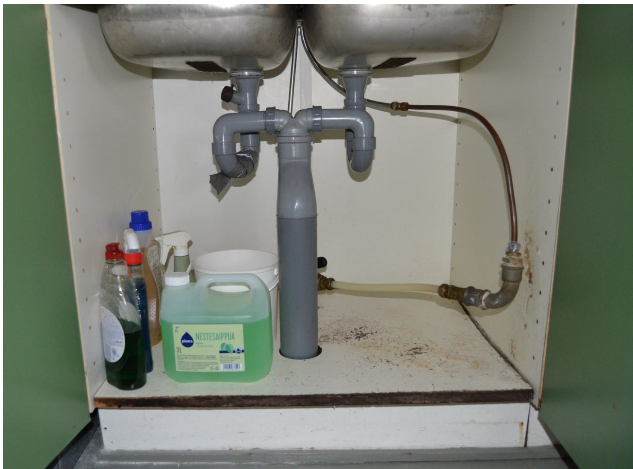
KUVA 46. Yleiskuva talon ainoasta vesipisteestä. Kuvassa keskellä kromin värinen vesiputki hanalta, joka on tulpattu virheellisesti (Heikkinen 2022).
