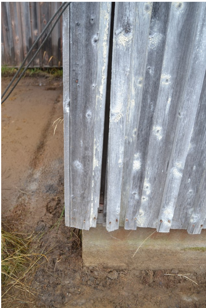
KUVA 19. Esimerkkikuva vauriosta ulkoverhouksessa (Heikkinen 2022)
