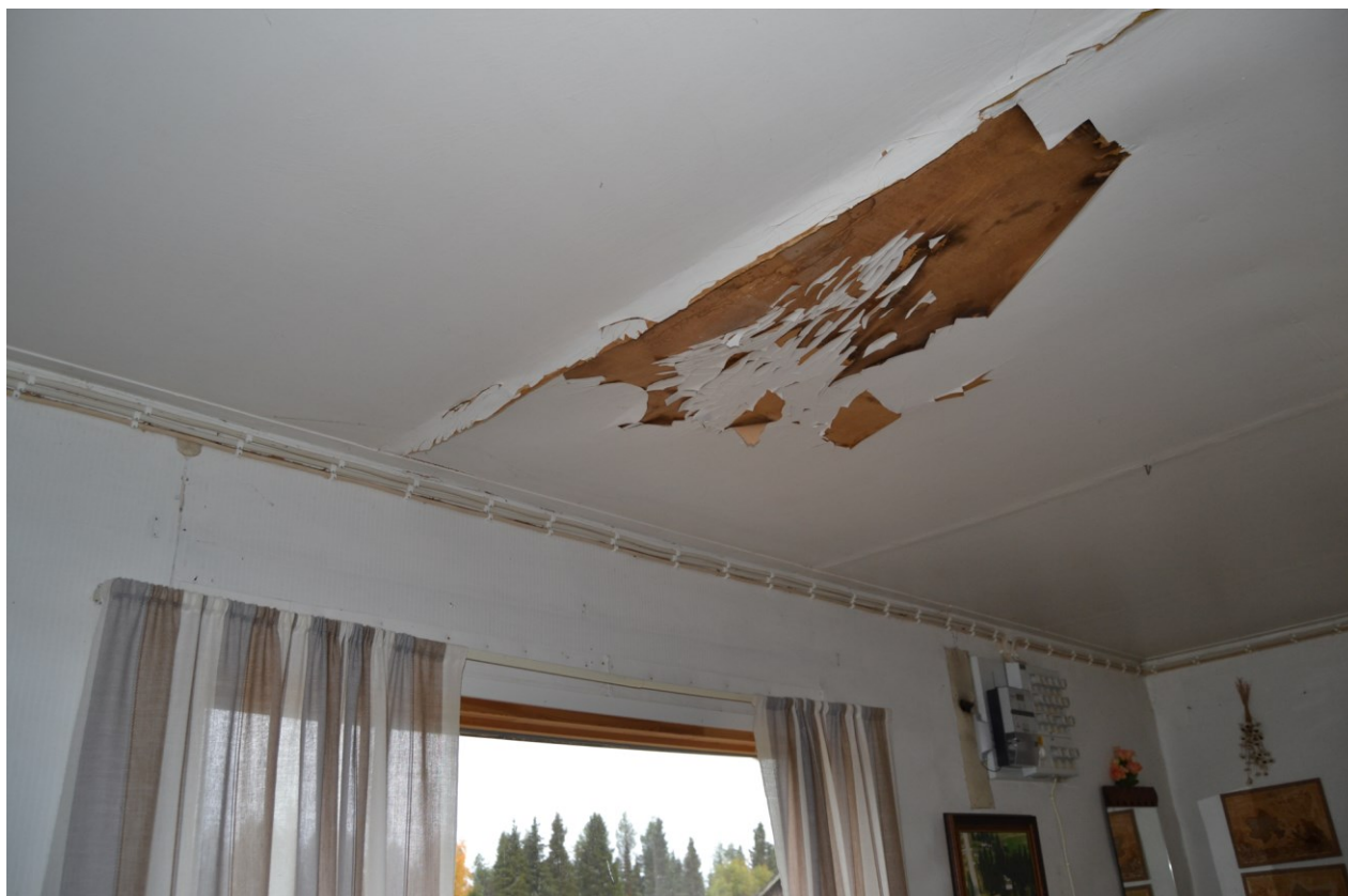
KUVA 30. Tuvan sisäkaton kosteusvaurio (Heikkinen 2022)
