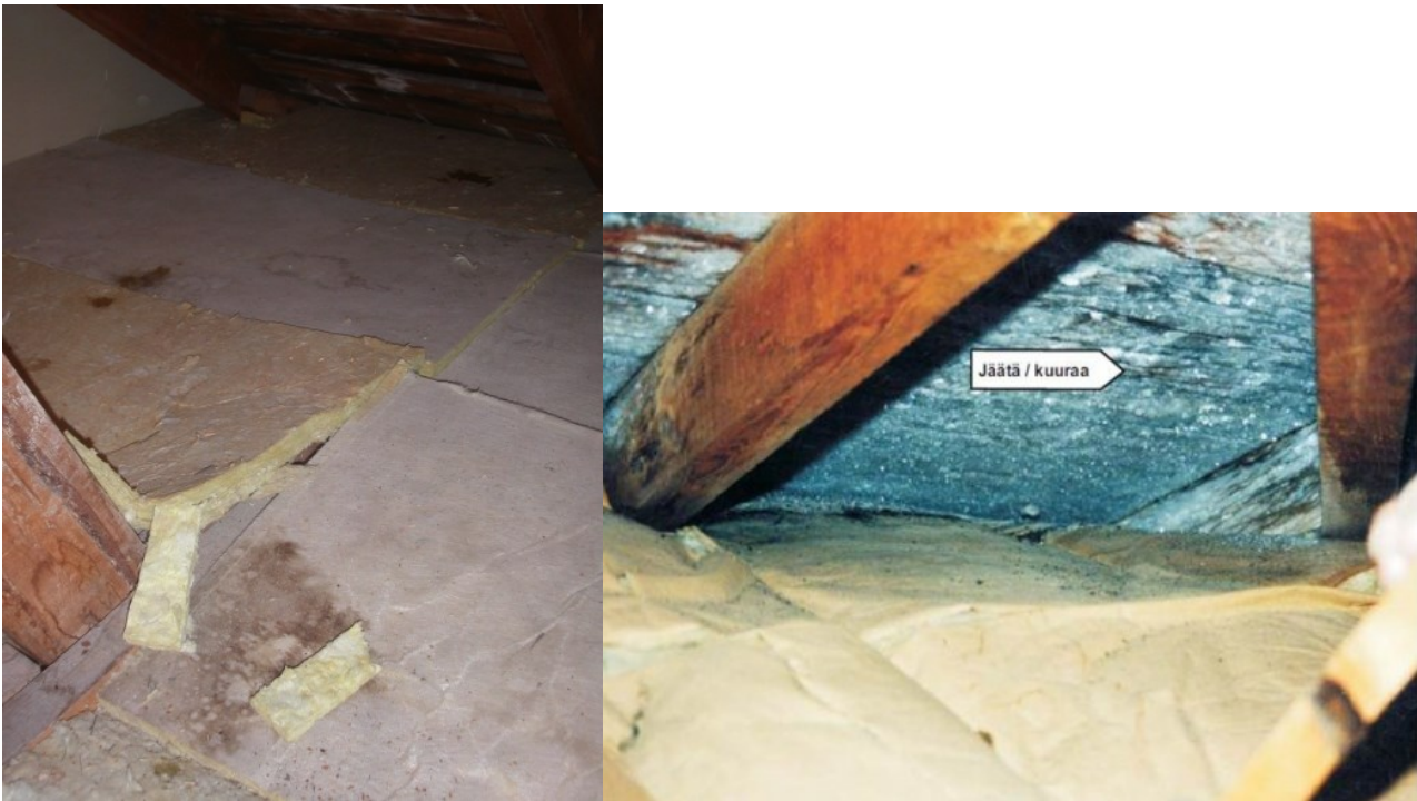
KUVA 20. Kuvaleike. Havainnollistavat kuvat lisälämmöneristyksen toteutuksesta väärin, jolloin tuuletusraot ovat tukkeutuneet ja vaurioitumismekanismit alkaneet. (Hometalkoot 2016.)
