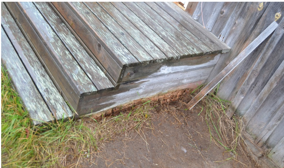
KUVA 10. Lahovauriota ulkoportaiden sivussa (Heikkinen 2022)
