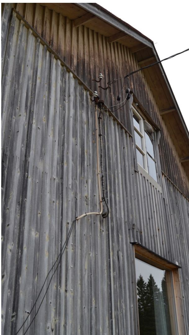
KUVA 48. Sähköjärjestelmää talon ulkoseinässä (Heikkinen 2022)
