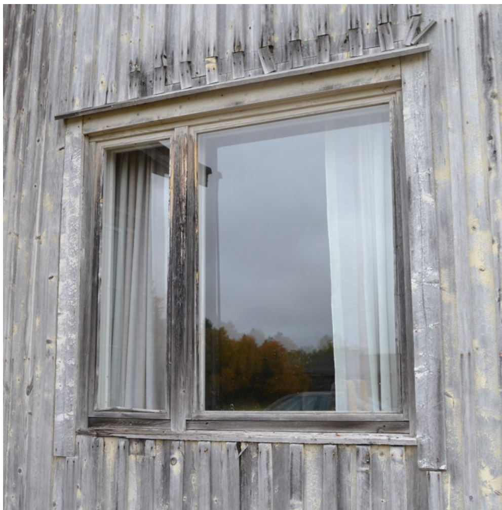
KUVA 21. Havainnollistava kuva siitä millaisia talon ikkunat ovat. Kaikki ikkunapielet ovat puisia ikkunan alalautaa myöten ja varsinkin se on herkkä vaurioitumaan kovan vesirasituksen vuoksi (Heikkinen 2022).
