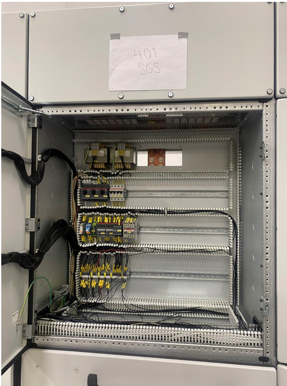
Kuva 11. Katkaisijan 4Q1 yläpuolella sijaitseva keskus (FAT Aineisto, 2022)
