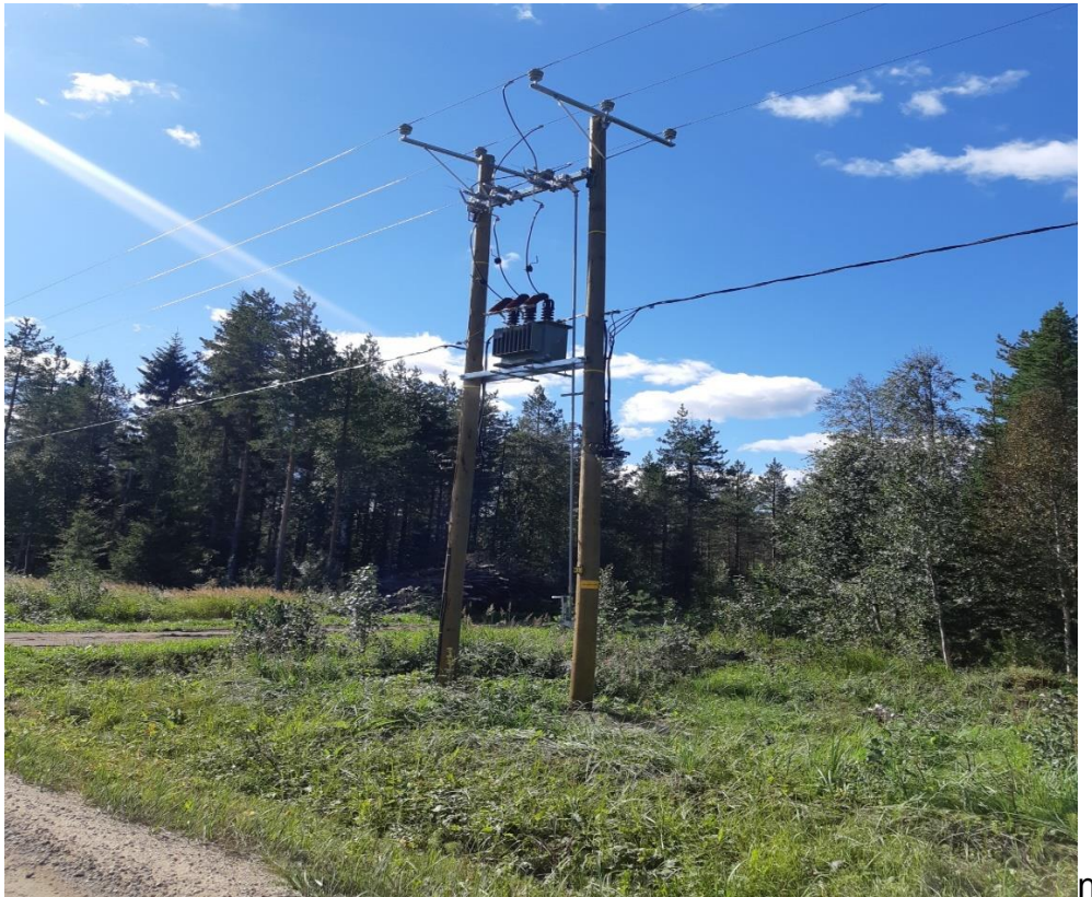
Kuva 7. Lehmikummun uusi ilmajohtoverkko
