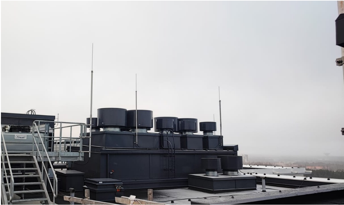
KUVA 33. Ulospuhallushajottimien suojaus eristetyillä sieppaustangoilla
