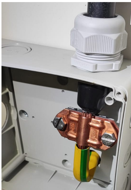
KUVA 29. Alastulojohtimen liitäntä- ja mittauspiste
