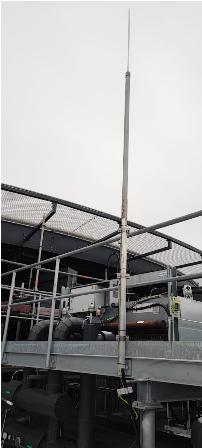
KUVA 32. Eristetyn sieppaustangon isCon-kaapelin pintapurkausmaadoitus
