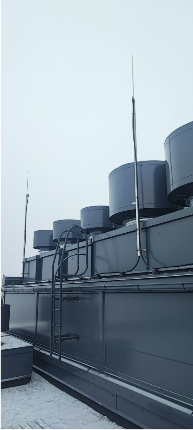
KUVA 36. Eristetyt sieppaustangot ketjutettuna toisiinsa isCon-johtimella
