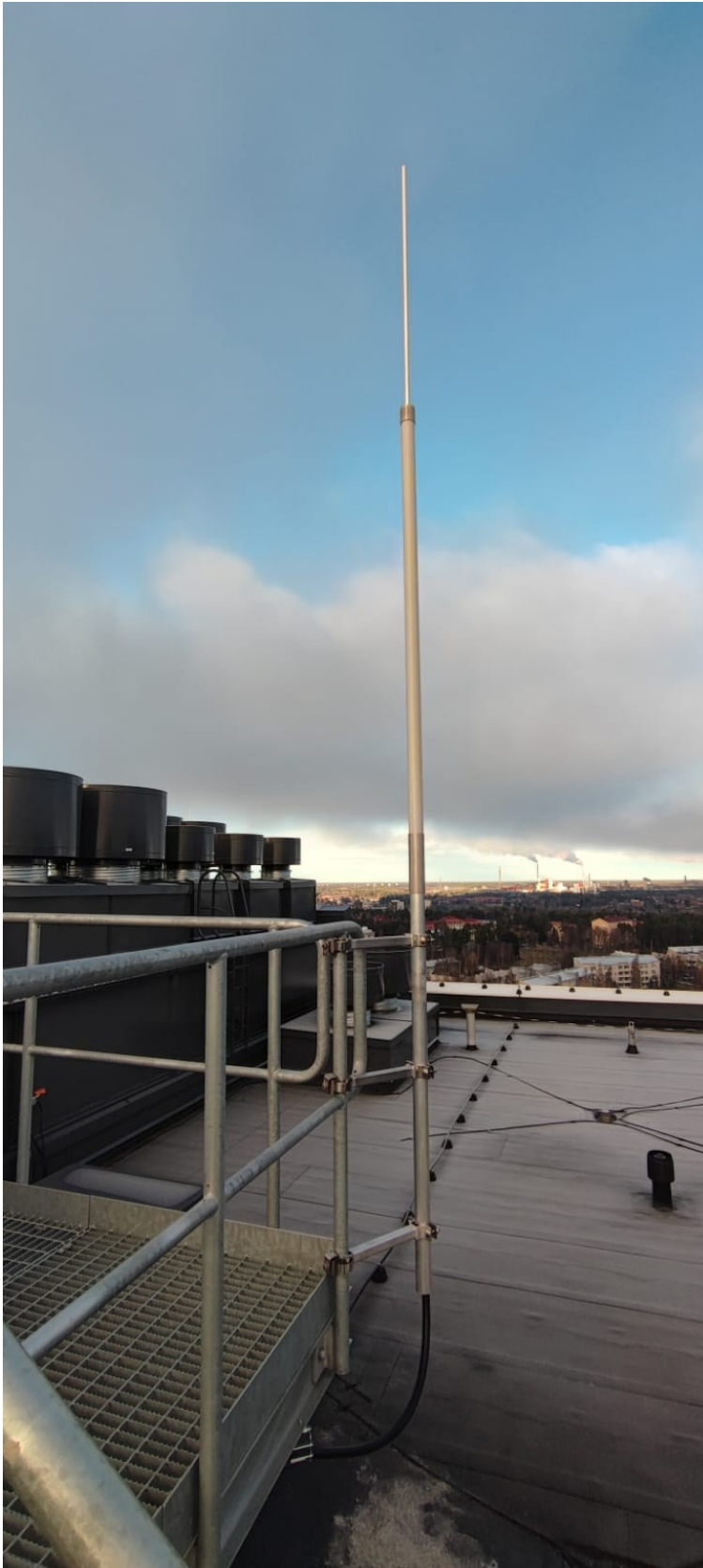
KUVA 35. Eristetty sieppaustanko kiinnitettynä kaiteeseen
