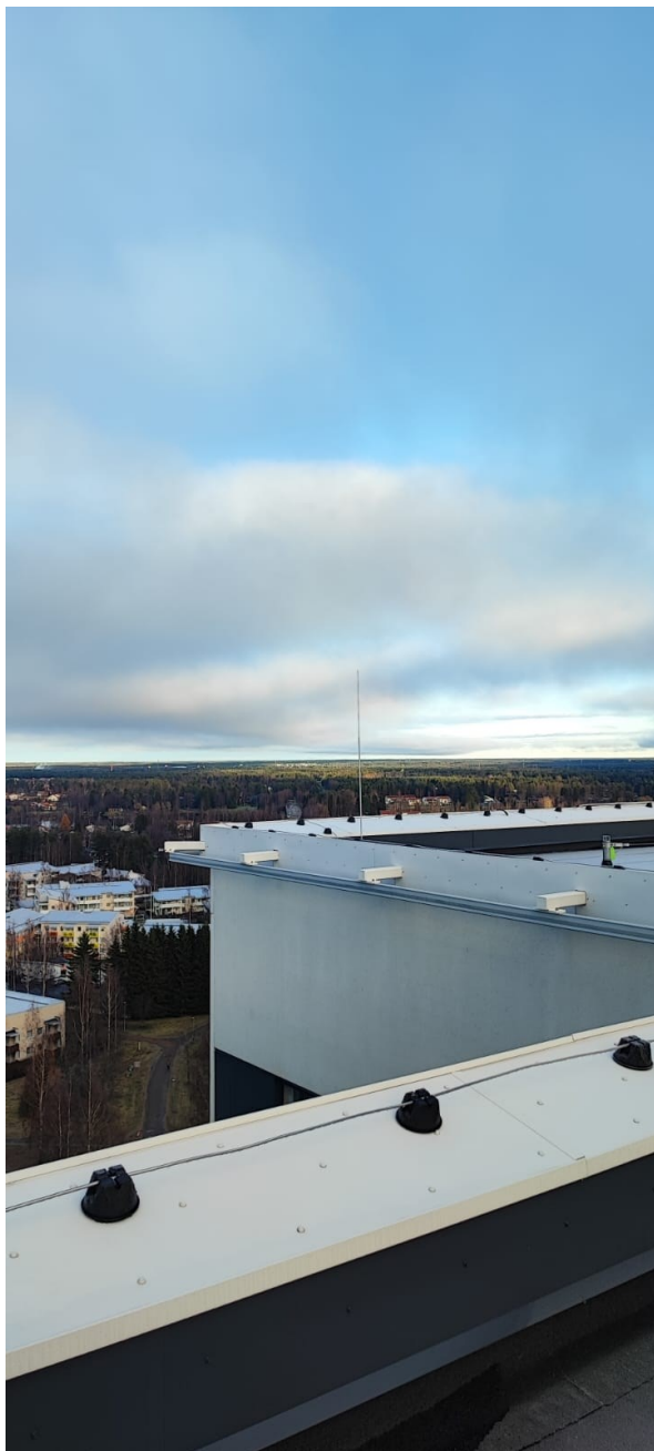
KUVA 30. Katon nurkissa on eristämätön sieppaustanko
