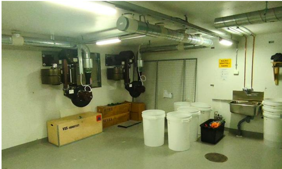
Kuvio 2: Väestönsuoja ja ilmanvaihtolaitteet
