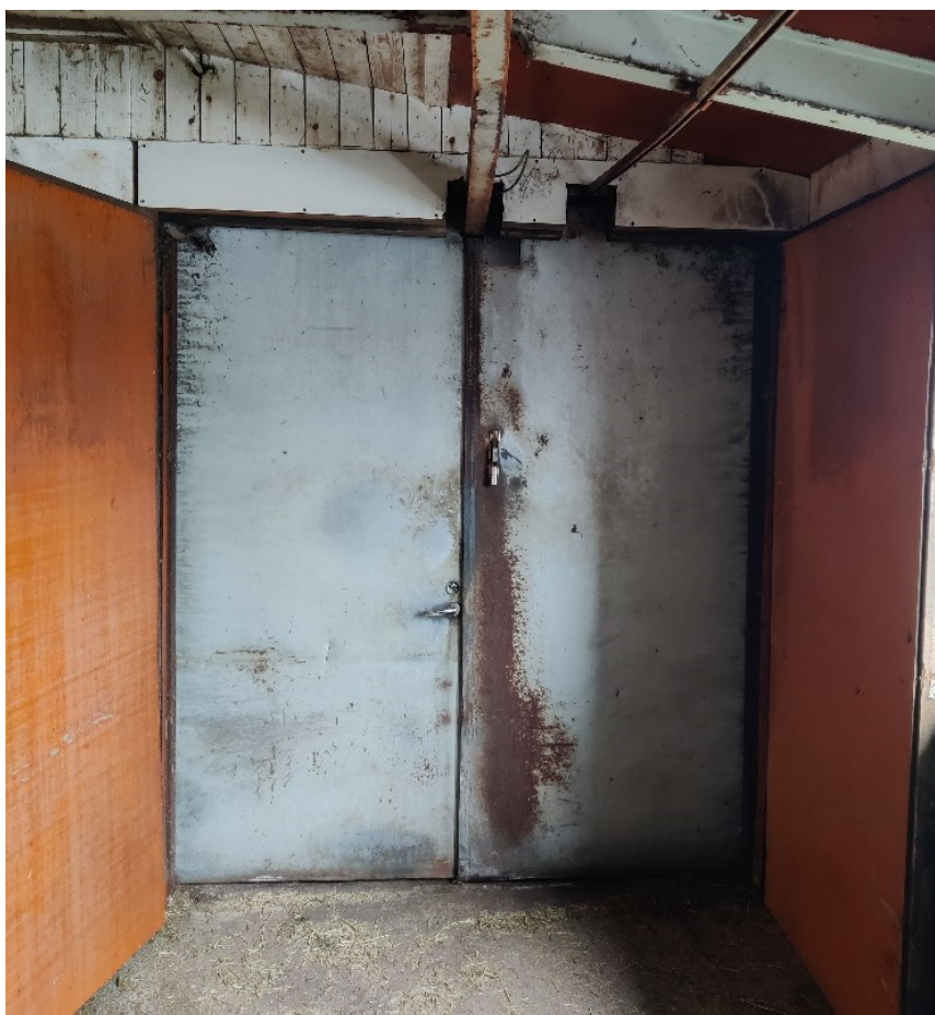
KUVA 11. Navetan ja rehuvaraston välinen palo-ovi (Hartikainen 2022j)
