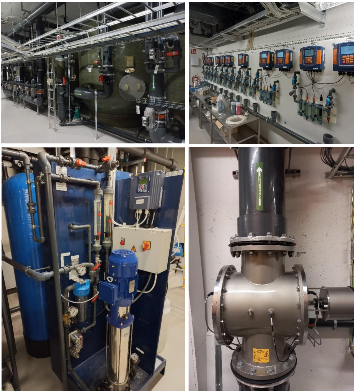
Kuva 9. Laitostilojen käytävältä kuva ylhäällä vasemmalla, ylhäällä oikealla päämittauspiste, alhaalla vasemmalla käänteisosmoosilaite ja oikealla UV- laite (kuva: Jarkko Virtanen).
