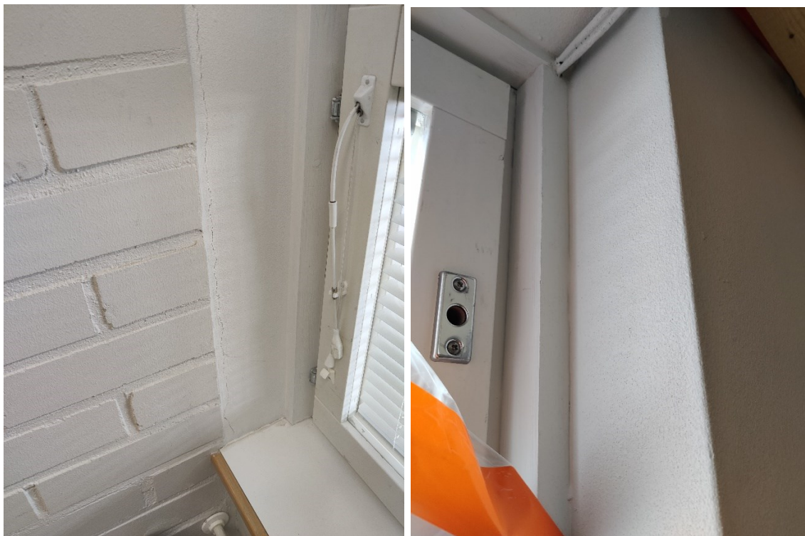
KUVAT 12 ja 13. Aiemmissa korjauksissa tiivistettyjä ikkunaliittymiä päiväkodin tiloissa. (Pesonen 2022, CC BY-SA)
