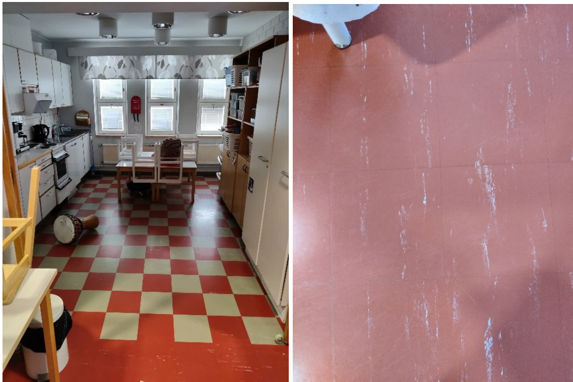
KUVAT 4 ja 5. Asbestikuituja sisältävällä kvartsivinyyli-laattalla päällystetty lattia kohteen lohossa 2. (Pesonen 2022, CC BY-SA)
