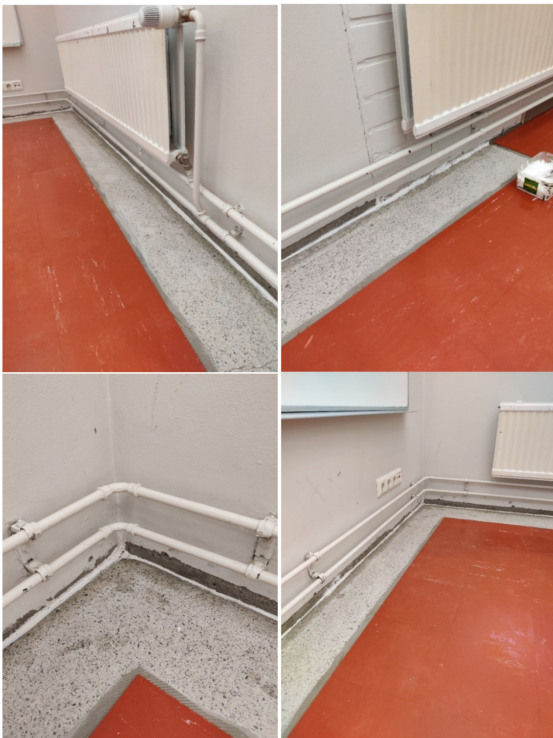
KUVAT 16, 17, 18 ja 19. Elastisella tiivistysmassalla tukittuja alapohjan ja ulkoseinän välisiä rakenneliittymiä päiväkodin tiloissa. (Pesonen 2022, CC BY-SA)
