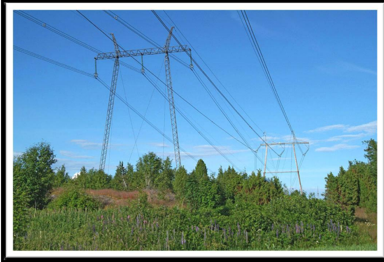
KUVA 4. 400 ja 110 Kilovoltin ilmajohtoverkot. (16, s.10.)
