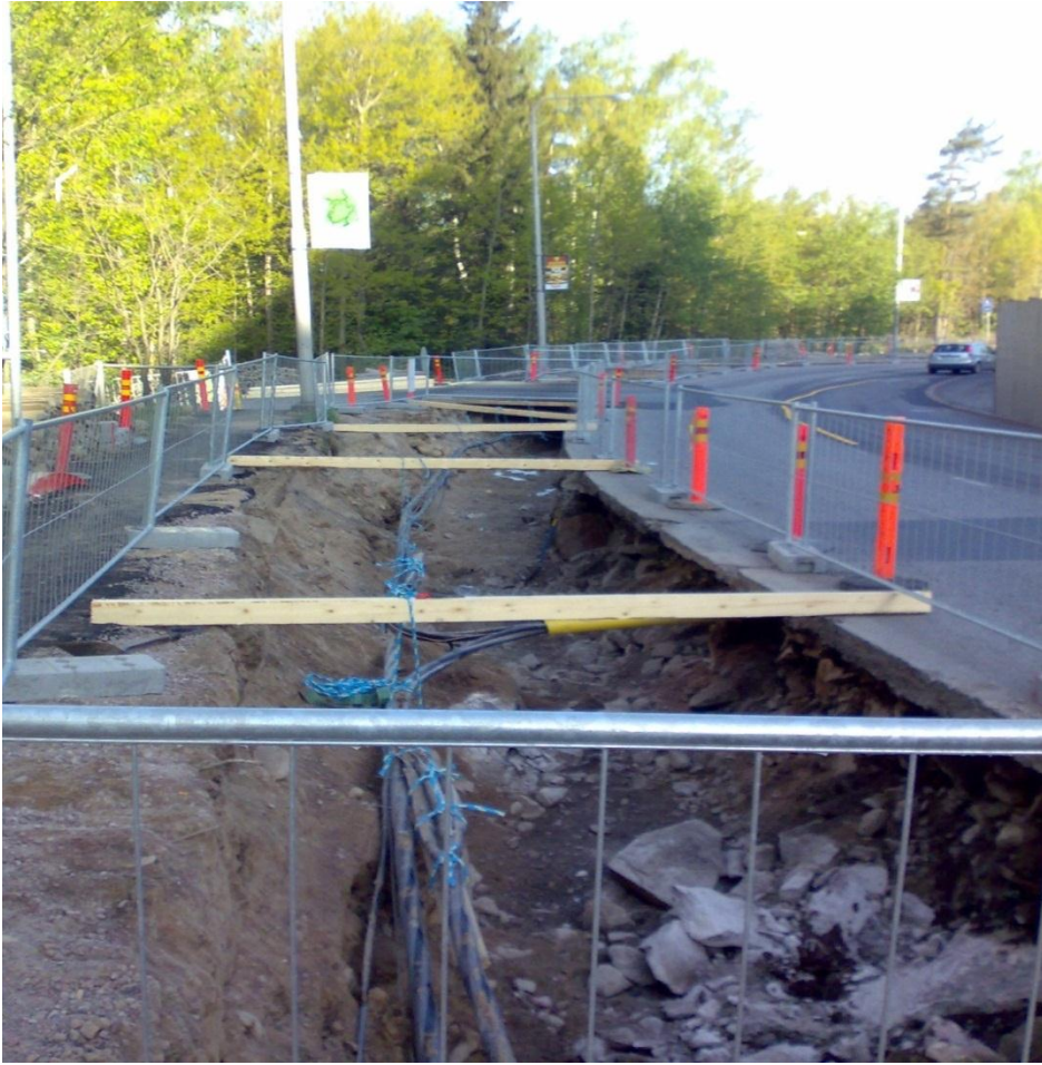
KUVA 8. Esimerkkejä hyvästä kaapelituennasta (15, s.17)
