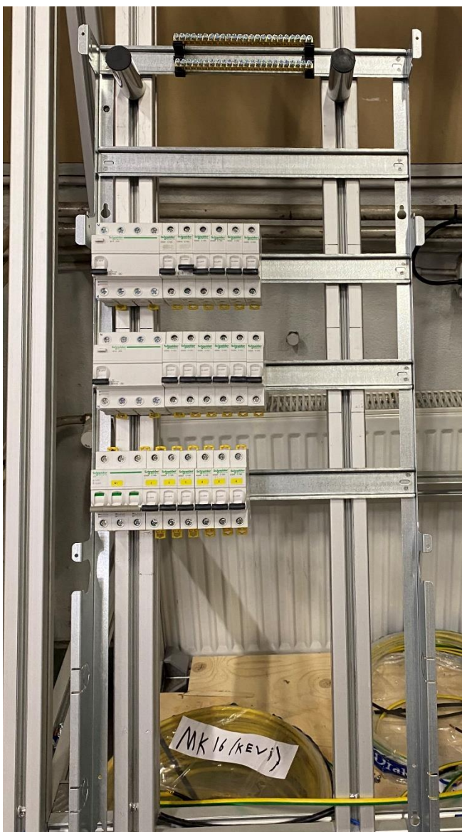
Kuva 2: RK4 mallinen runko johon kiinnitetty Komponentteja ja N/PE-kisko
