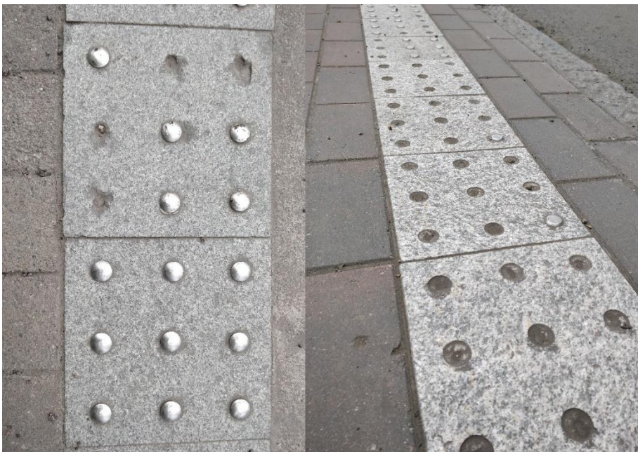
Kuva 6 Ehjä ja vaurioituneita opaslaattoja (Kuva: Anna Vartiainen)
