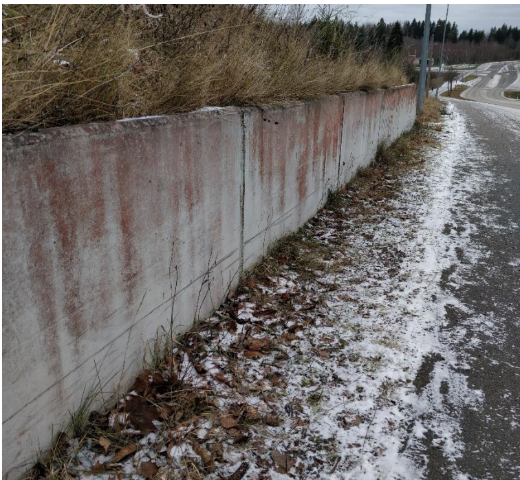
Kuva 5 Punajakälän värjäämä betonitukimuri (Kuva: Anna Vartiainen)
