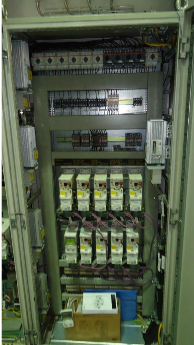
Kuvio 5. Pienitehoiset taajuusmuuttajat sähkökaapissa
