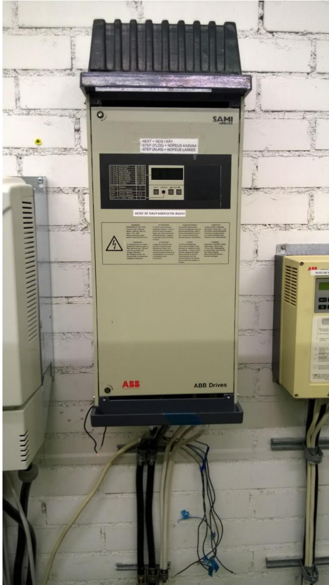
Kuvio 12. Taajuusmuuttaja asennettuna tiiliseinälle
