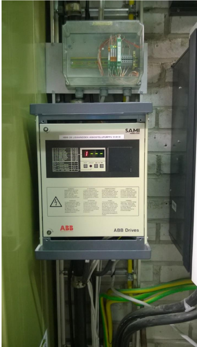
Kuvio 11. Taajuusmuuttaja asennettuna kaapelihyllylle
