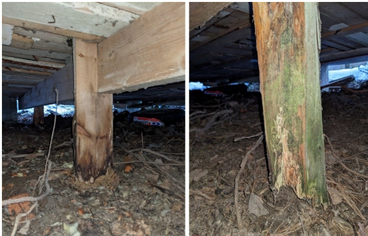
Kuva 12 Lisätuenta on vaurioitunut.
