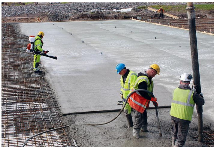
Kuva 1. Massiivisen betonirakenteen valua. Kuvassa vasemmalta oikealle betonin jälkihoitoa jälkihoitoaineella, betonipinnan tasoitus, betonin tiivistys täryttimellä ja betonin valamisen muottiin pumppaamalla. (kuva muottikolmion kotisivun selitekuva)
