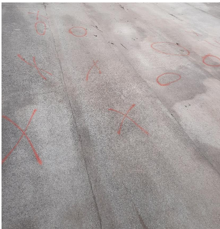
Kuva 3. Osmoosikuplia vedeneristuksessa (kuva Oskari Rämö)
