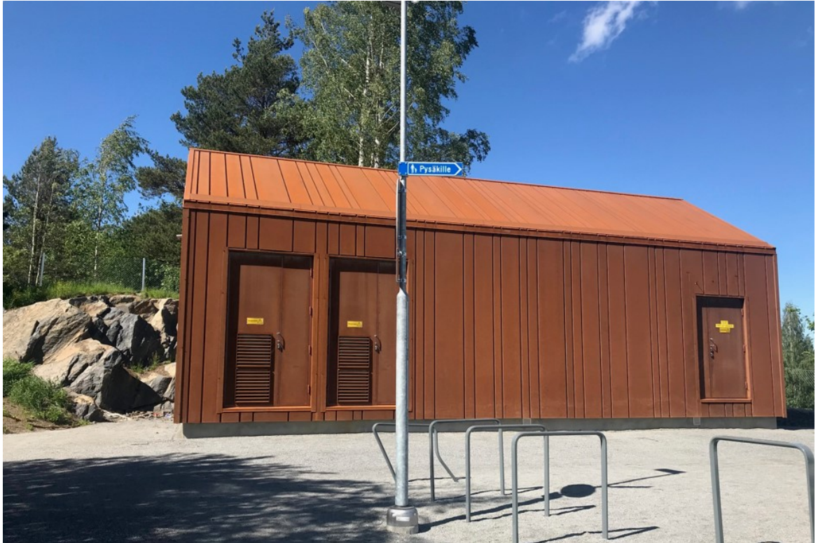
Kuva 4. Sähkösyöttöasema SSA09 Turtola
