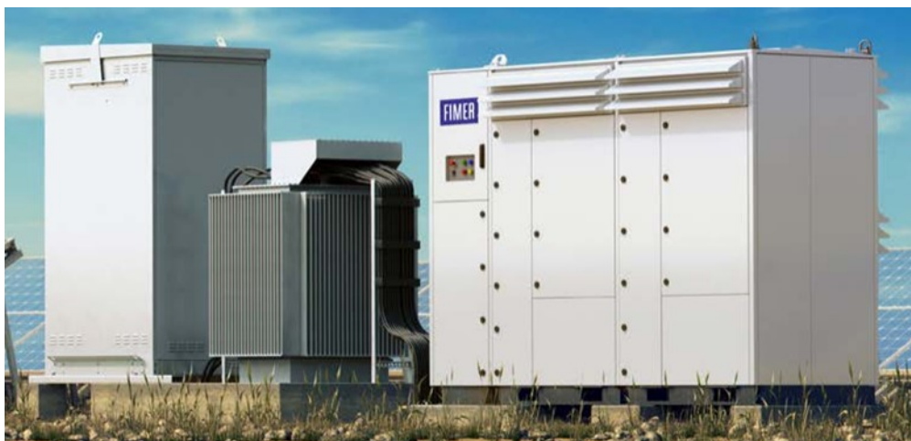
KUVA 4. Kuvassa vasemmalla on kytkinlaitteisto, keskellä jakelumuuntaja, sekä oikealla keskusinvertteri (FIMER 2021.)
