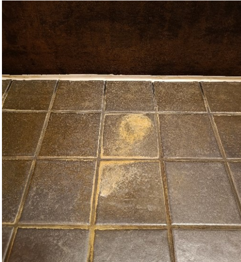
Kuva 3. Raudan värjäämä alue pesuhuoneen lattiakaakeleissa
