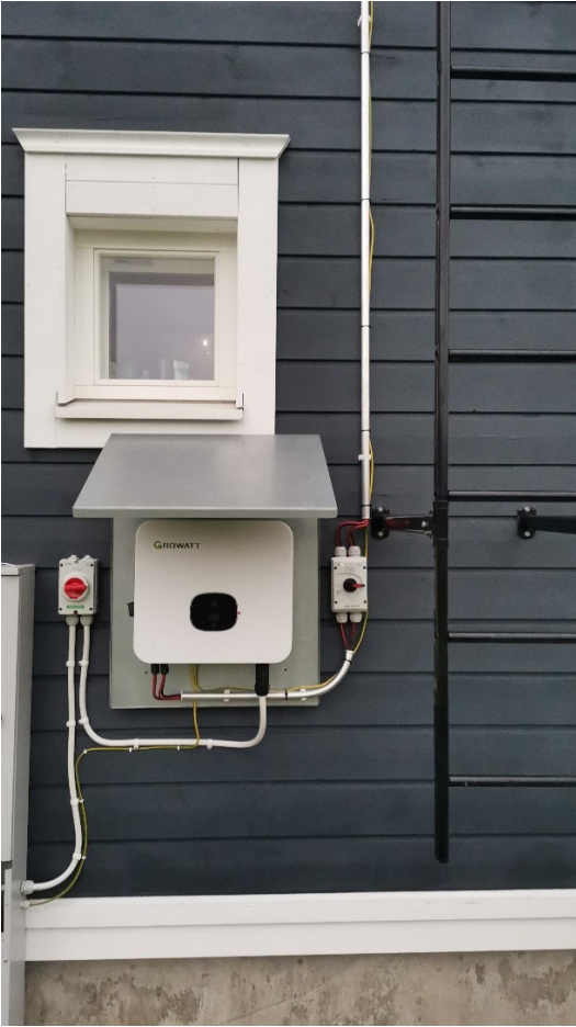
Kuva 11. Inverteri ja katkaisijat seinälle asennettuna (Hautamäki, 2022).
