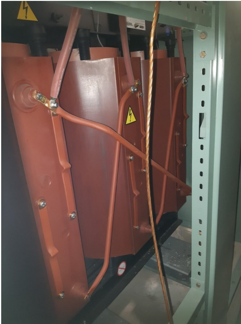
Kuva 7. Kuvassa eräs kuivamuuntaja 10 kV kytkennällä. (Rasi, 2022.)
