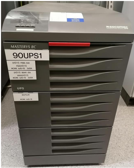
KUVA 28. Socomec Masterys BC 15 kVA kojeistossa 4.
