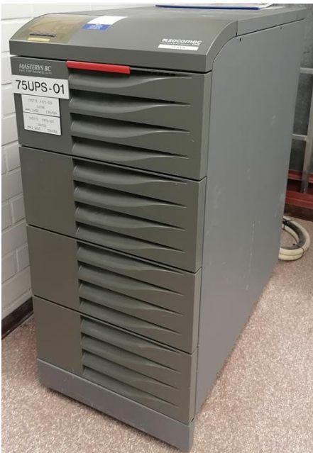
KUVA 25. Socomec Masterys BC 15 kVA kojeistossa 1.
