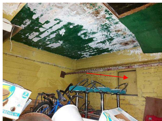
Kuva 8. Moottoripyöräkerhotilojen yläpuolella on öljysäiliötila, johon on luukku kerhotiloista. Luukun takana oleva tila on todennäköisesti saastunut asbestista.
