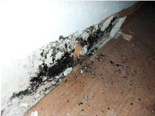
Kuva 3. Kuivien tilojen välipohjassa asbestia sisältävää bitumikermiä.
