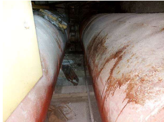
Kuva 22. Öljysäiliöt on sijoitettu autohallin yläpuolelle. Lattialla ja säiliöiden pinnalla öljyjäämiä.
