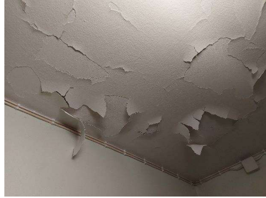
Kuva 15. Ensimmäisen kellarikerroksen kattomaalit sisältävät vaarallisen jätteen raja-arvon ylittäviä pitoisuuksia lyijyä.
