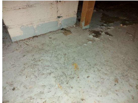
Kuva 17. Autohallin moottoripyörekerhotilojen vaalean harmaa betonilattian maali sisältää haitallisen jätteen ylemmänohjearvon ylittäviä pitoisuuksia lyijyä.
