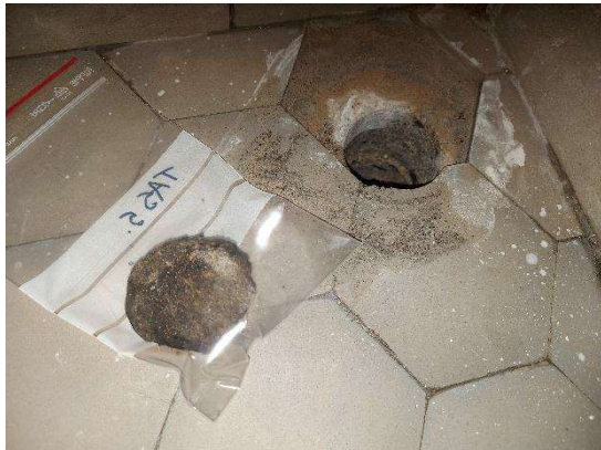
Kuva 1. Alkuperäisten wc-tilojen vedeneristebitumikermit sisältää asbestia.
