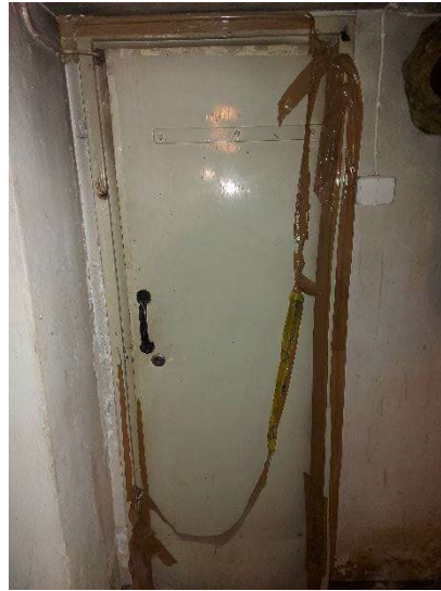
Kuva 10. Lämmönjakohuoneesta käynti öljysäiliötilaan, jossa pinnoilla asbestia.
