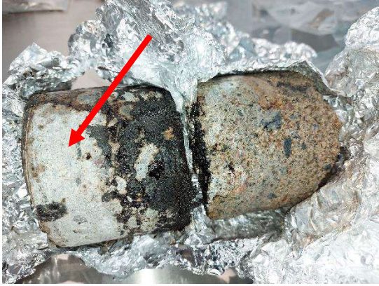
Kuva 19. Autohallin moottoripyöräkerhotilojen alapohjan pintalaatta sisältää vaarallisen jätteen raja-arvon ylittäviä pitoisuuksia öljyhiilivetyjä.
