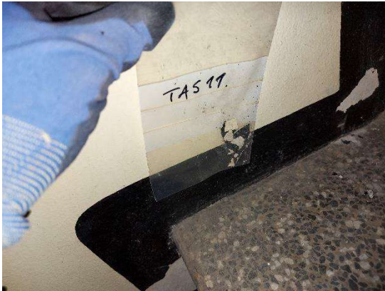
Kuva 16. Porraskäytävän porrasaskelmien jalkalistan maalit sisältävät vaarallisen jätteen raja-arvon ylittäviä pitoisuuksia lyijyä.
