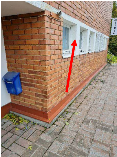
Kuva 18. Julkisivujen ja ikkunanpielien valkoinen maali sisältää vaarallisen jätteen raja-arvon ylittäviä pitoisuuksia lyijyä.
