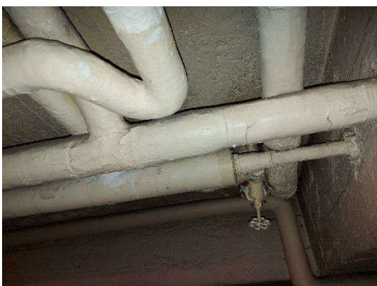
Kuva 7. Putkieristeet sisältävät asbestia. Putkieristeitä on alapohjissa, välipohjissa, hormeissa, koteloissa ja alakattojen sisällä näkyvien putkien lisäksi.
