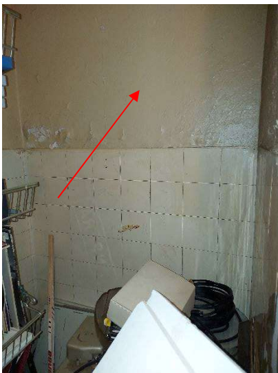
Kuva 5. Alkuperäisen pesuhuonetilan seinätasoite sisältää asbestia.
