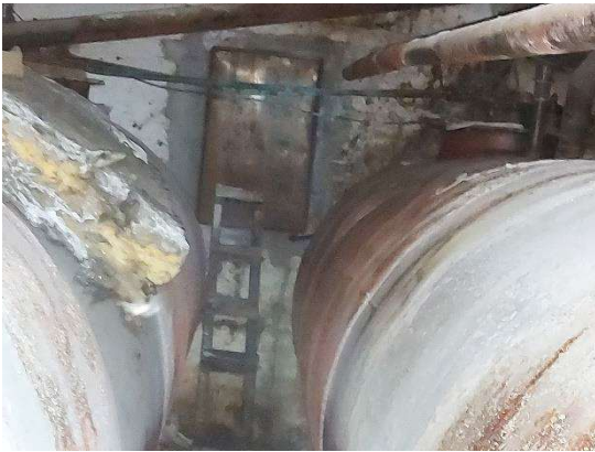
Kuva 9. Öljysäiliötila ja lämmönjakohuone ovat saastuneet asbestista.
