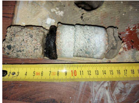
Kuva 4. Alkuperäisten sauna- ja pesuhuonetilojen vedeneristebitumikermi sisältää asbestia.
