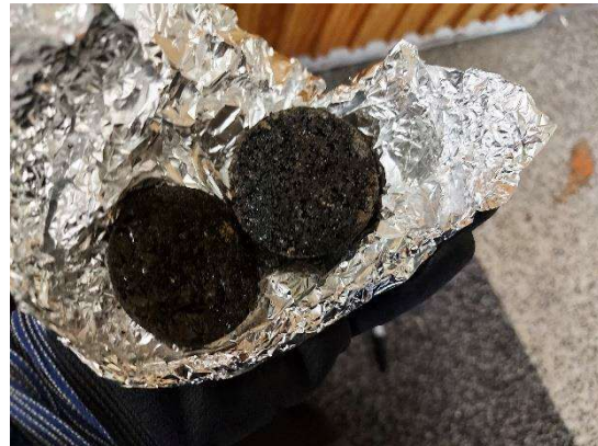
Kuva 2. Välipohjarakenteiden vedeneristebitumikermit sisältää asbestia.
