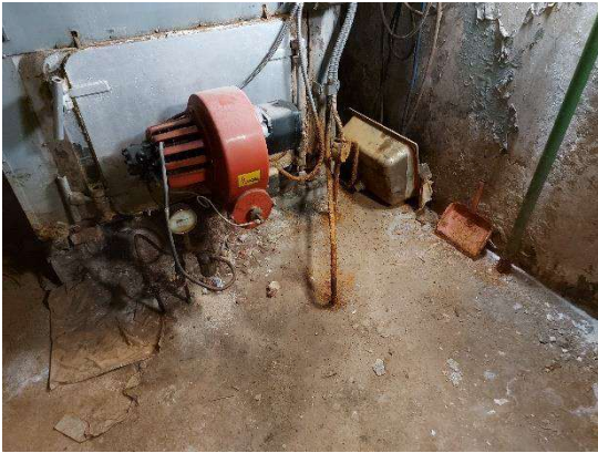
Kuva 11. Lämmönjakohuoneen pinnoilla asbestia. Lämmönjakohuoneen pohjakerroksessa on vanhoja öljykattiloita, joiden rakenteissa on myös asbestia.
