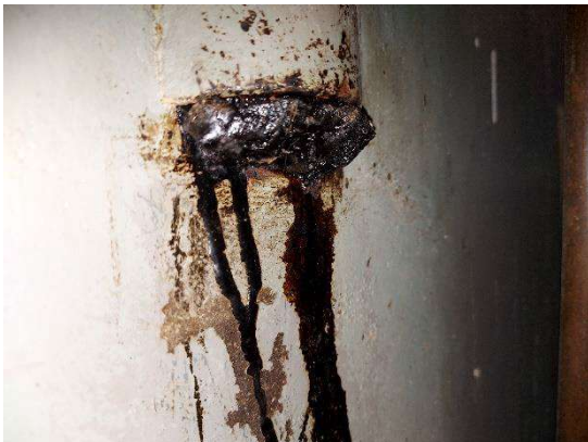
Kuva 23. Avoin öljyputki ja näkyviä öljyvuotojälkiä maanvastaisessa seinärakenteessa ja alapohjarakenteessa lämmönjakohuoneessa.
