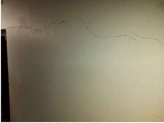
Kuva 14. Ensimmäisen kellarikerroksen sisäseinien maalit sisältävät haitallisen jätteen raja-arvon ylittäviä pitoisuuksia lyijyä.
