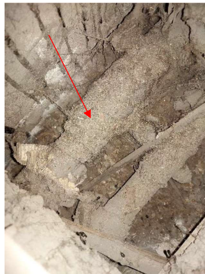
Kuva 6. Alkuperäiset putkieristeet sisältävät asbestia.
