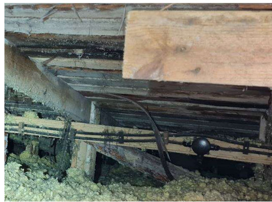
Kuva 13. Alkuperäiset sähkökaapelit voivat sisältää PAH-yhdisteitä.
