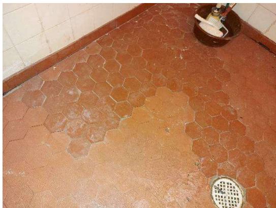
Kuva 12. Ensimmäisen kerroksen alkuperäisten märkätilojen vedeneristebitumisively sisältää PAH-yhdisteitä.
