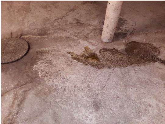
Kuva 21. Autotallien lattialla näkyviä öljyläikkiä koko alapohjan alueella.
