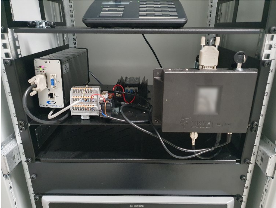
Kuva 22. Virve-radiovastaanotin ja Ylli-liitäntäyksikkö
