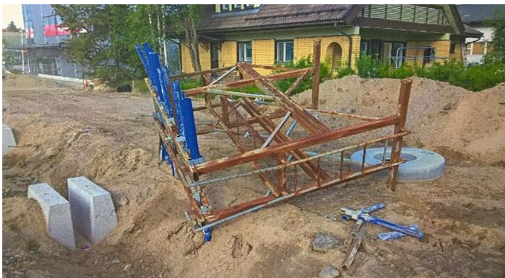
Kuva 2. Huonosti pohjustettu elementtiteline kaatui (23).
