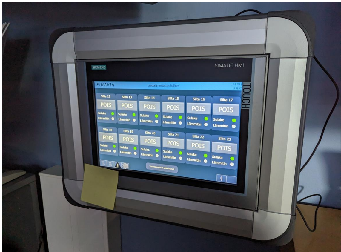
Kuva 22. HMI sijoitettuna valvomoon.
