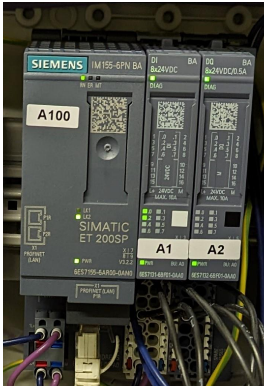
Kuva 8. Koottu hajautettu IO asennuksessa.
