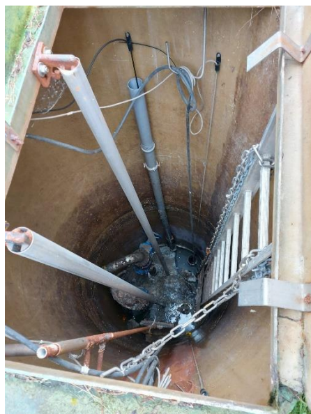
Kuva 3 jäteveden pumppaamo / Kallioniemi
