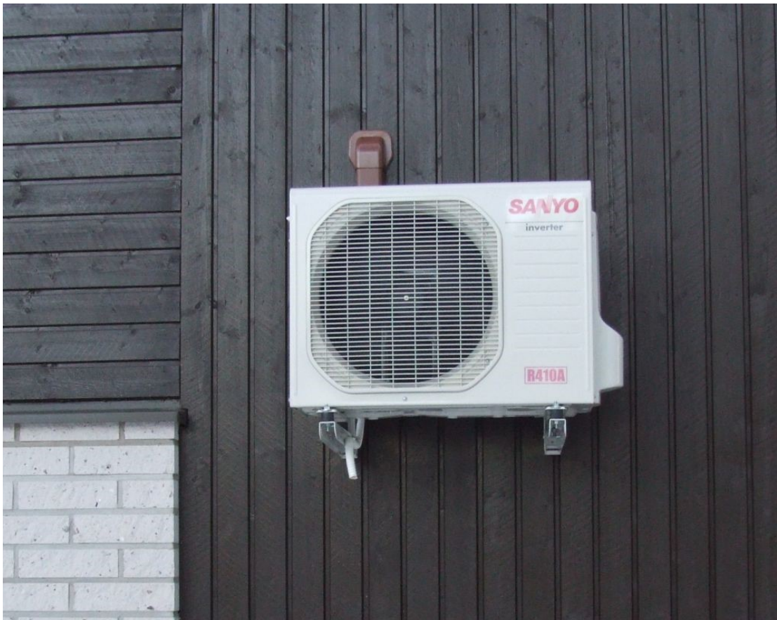
KUVA 5. Ilmalämpöpumpun ulkoyksikkö seinäkiinnityksellä.
