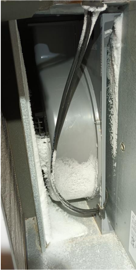
KUVA 50. Jäähileen kertyminen ilmanvaihtokoneen jäteilmakammioon
