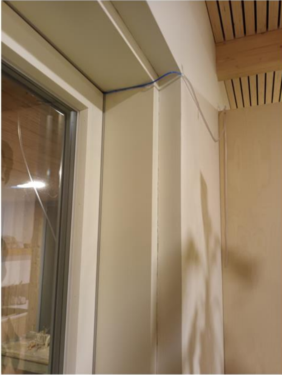
KUVA 35. Alakerran mittauspiste ja indikointiletkun johtaminen ulkoilmaan
