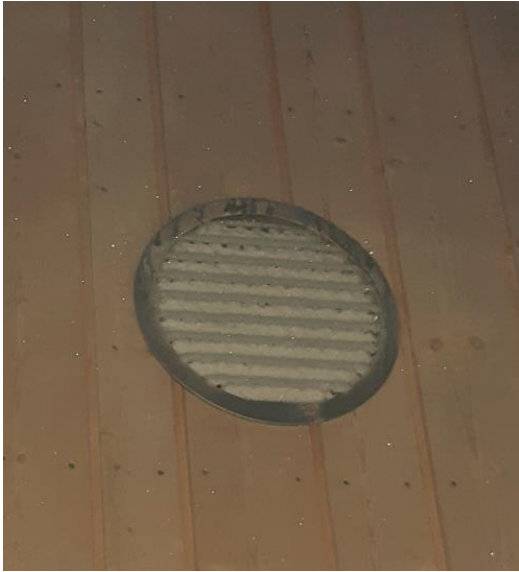
KUVA 13. Ulkoilmalaitteen tukkeutuminen ulkoisista tekijöistä
