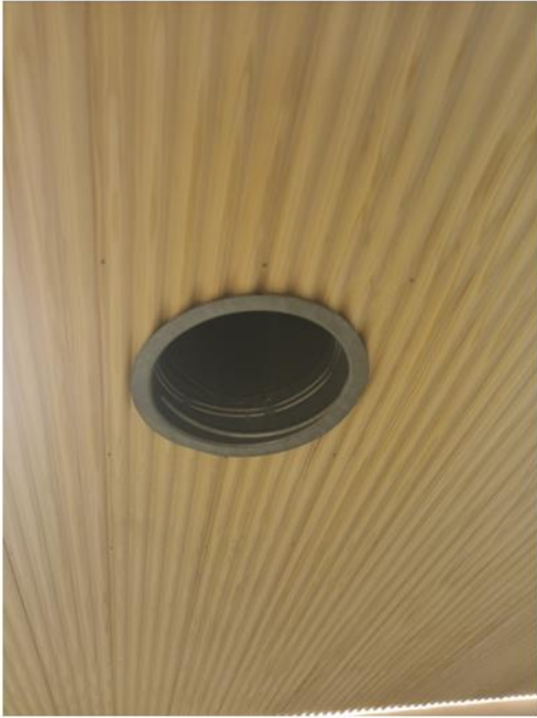
KUVA 61. Irrotettu poistoilmaventtiili ja avoin poistoilmakanava
